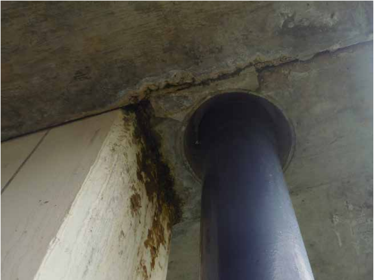
1.OG Risse Balkonplatte unter Ablauf Balkon
