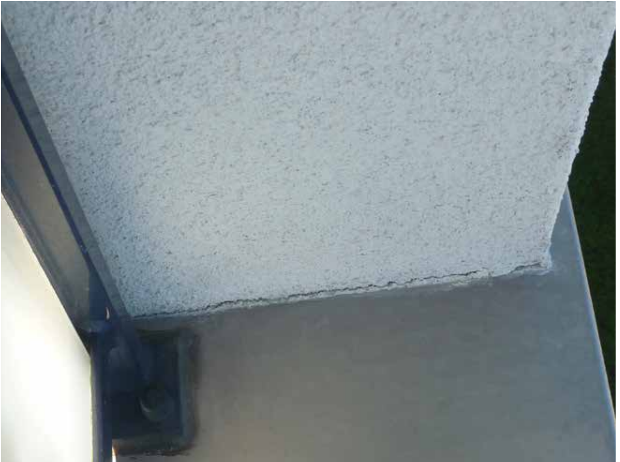
offene Fuge bei Anschluss Kronenabdeckung Dachrand an AWD (kein Putzbord)
