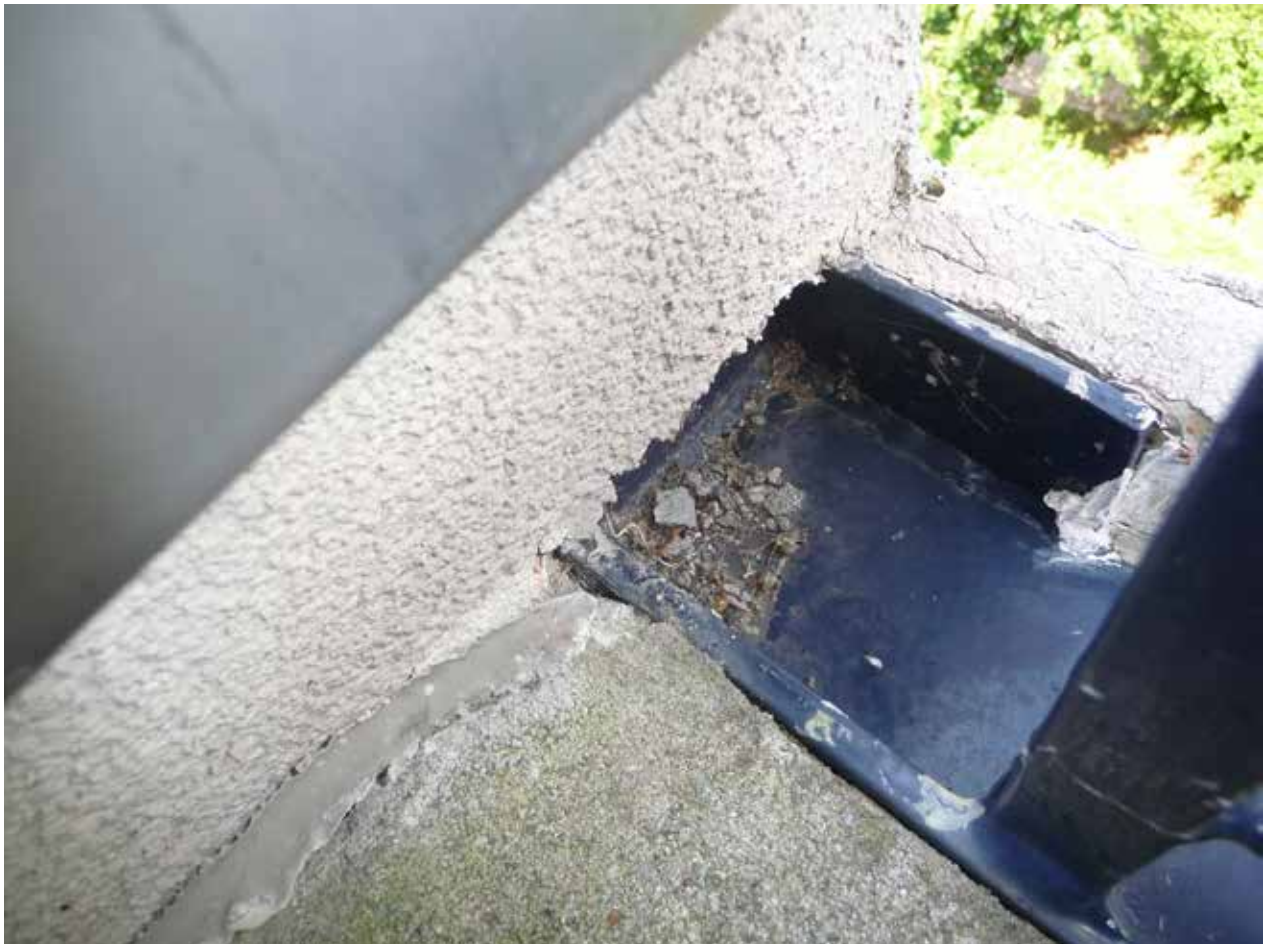
DG Putzschäden, fehlende Abdeckbleche bei Anschluss Laubengang an AWD
