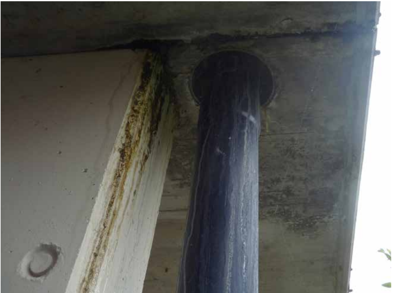
EG Risse Balkonplatte bei Ablauf Balkon (Schnäuze an Trennwand)
