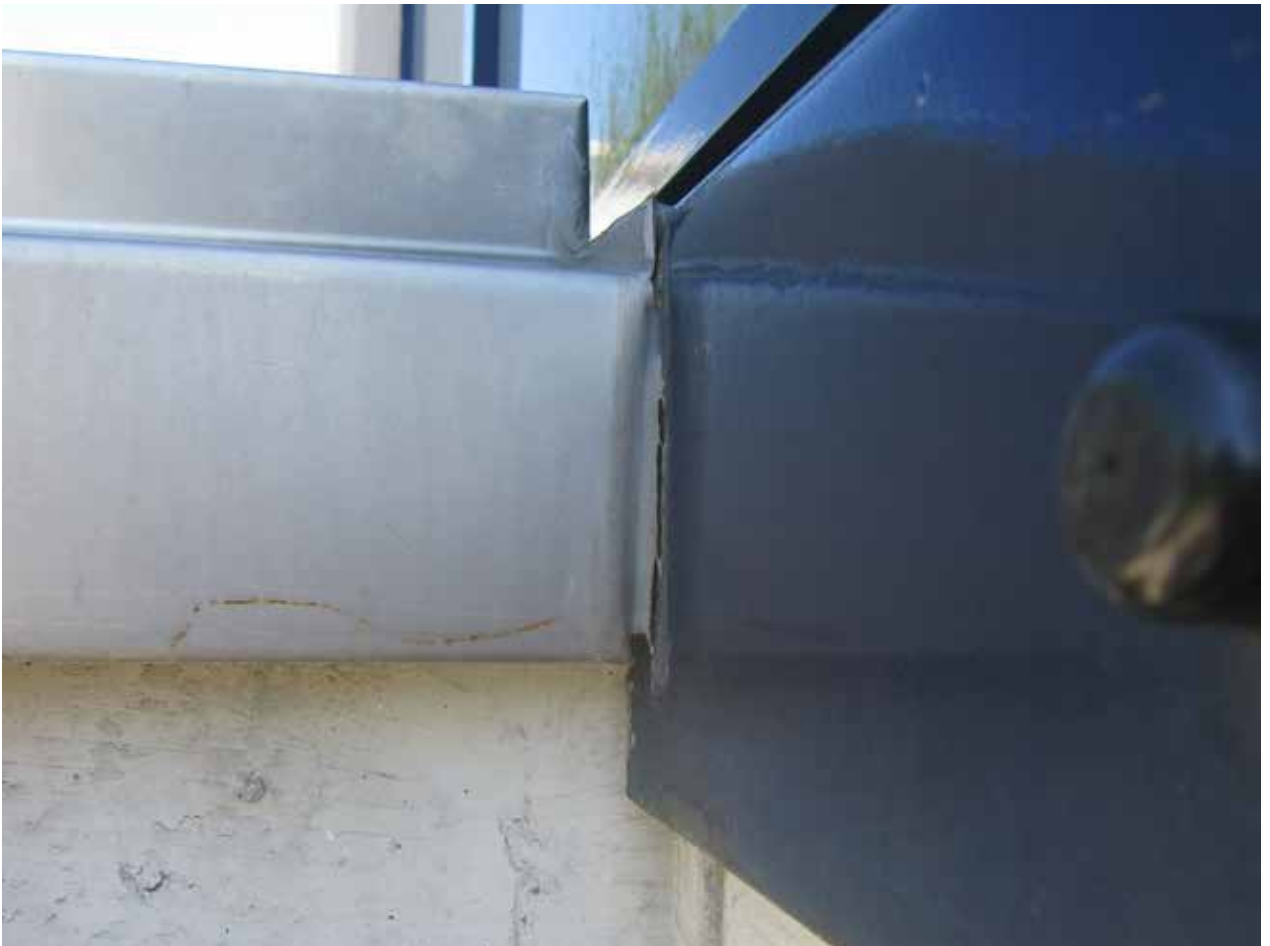
EG ablösene Fuge zwischen Dachrand Vordach und Geländer Laubengang
