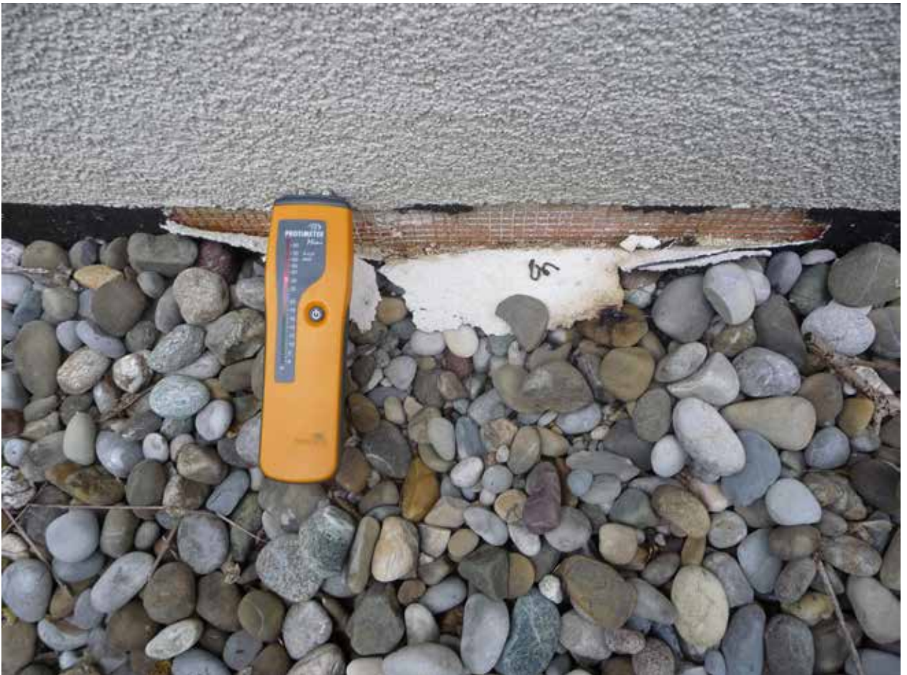
Putzschäden AWD bei Fassadensockel
