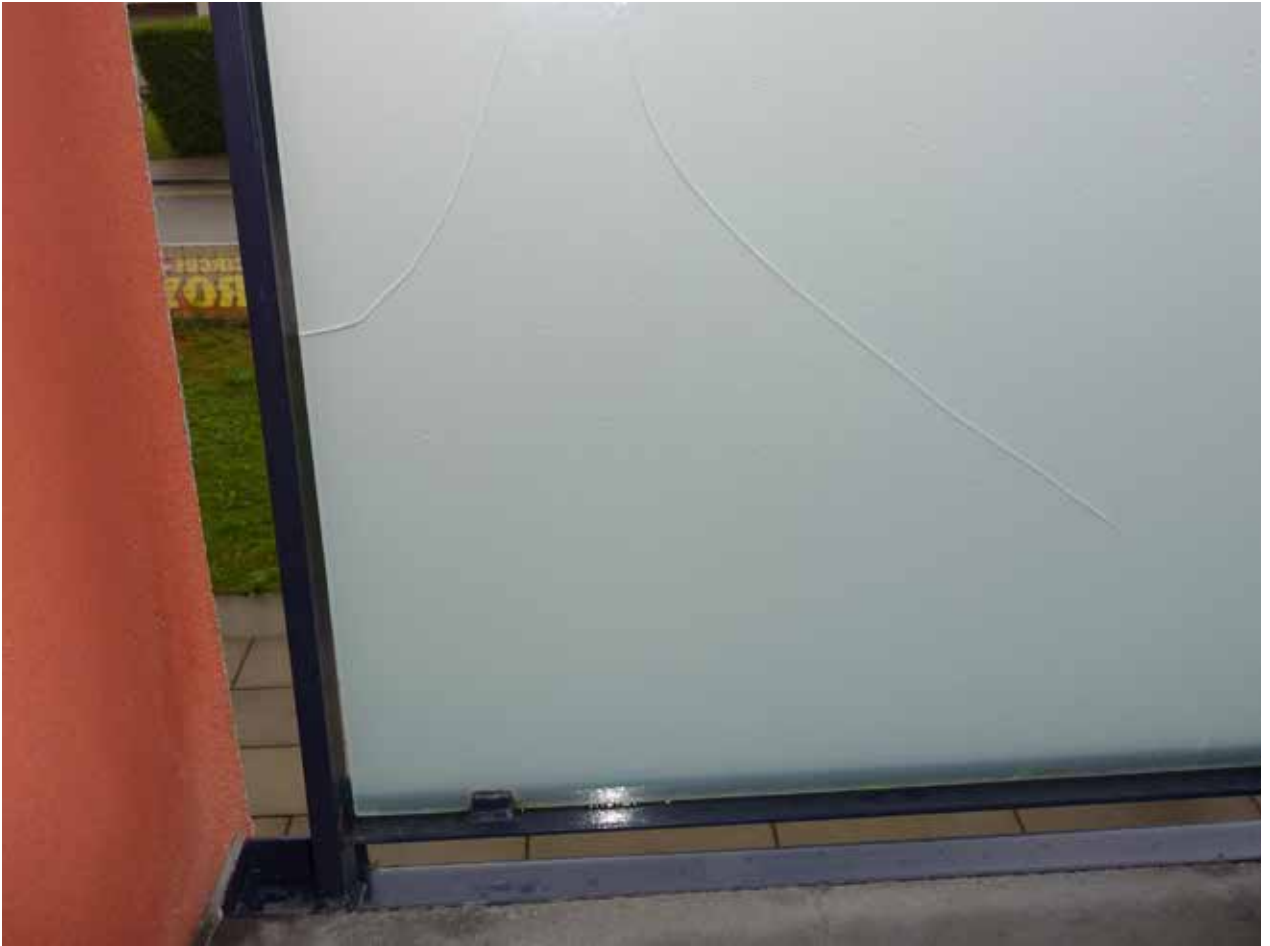
1.OG defektes Glas bei Geländer Laubengang
