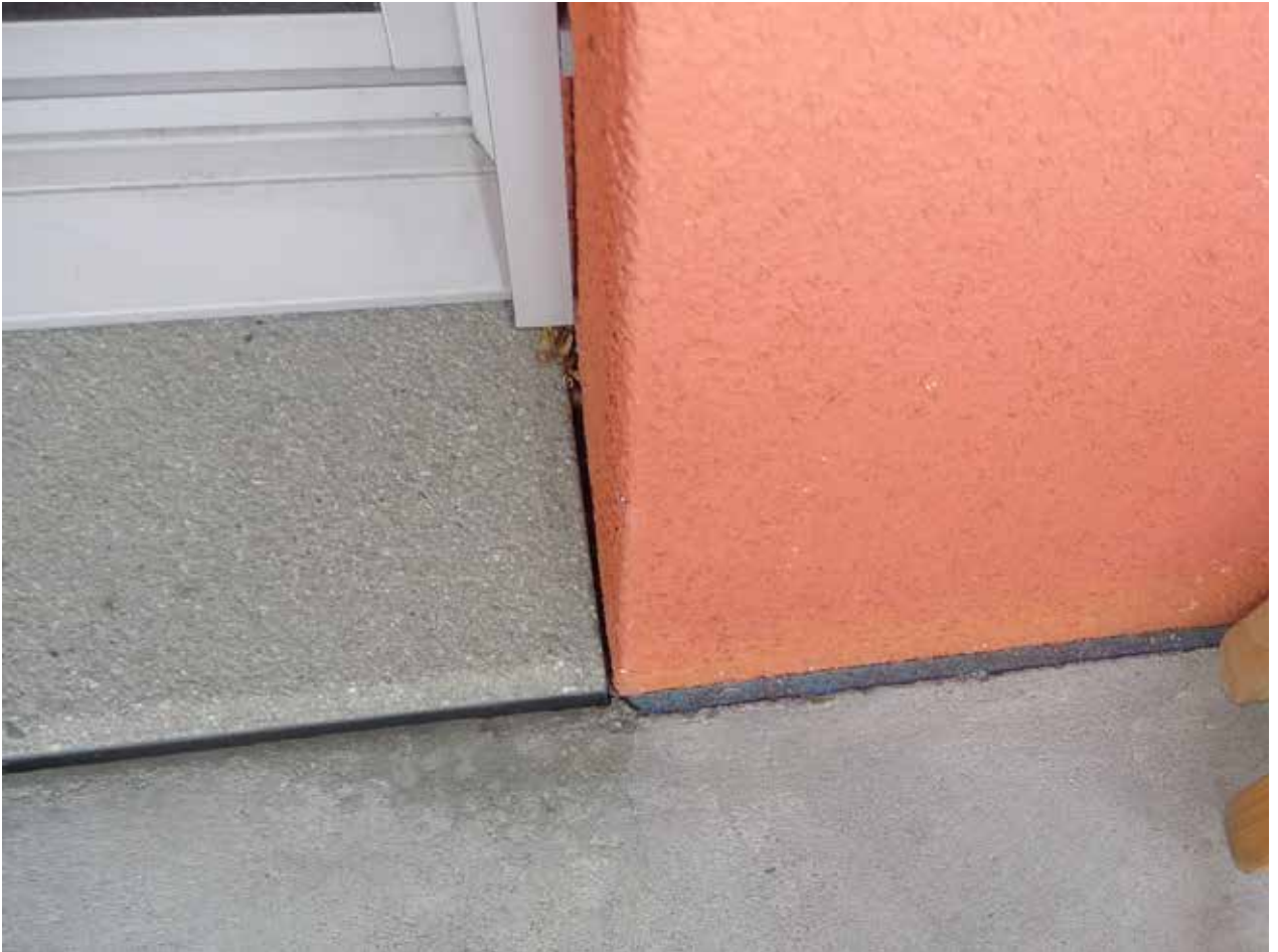
2.OG Anschlussfugen Balkonplatte an Fassade und an Balkontrennwände fehlen im ganzen Haus
