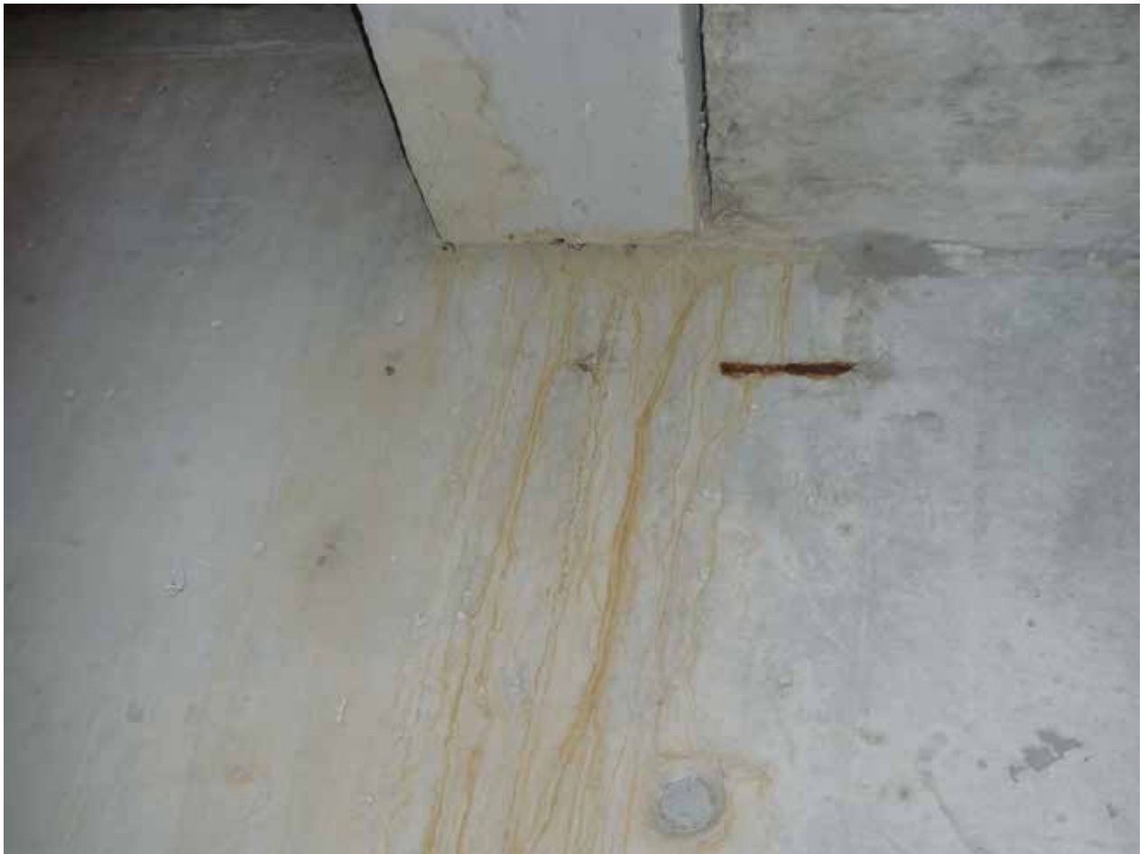
Wassereintritte UG Treppenhaus unter Treppe
