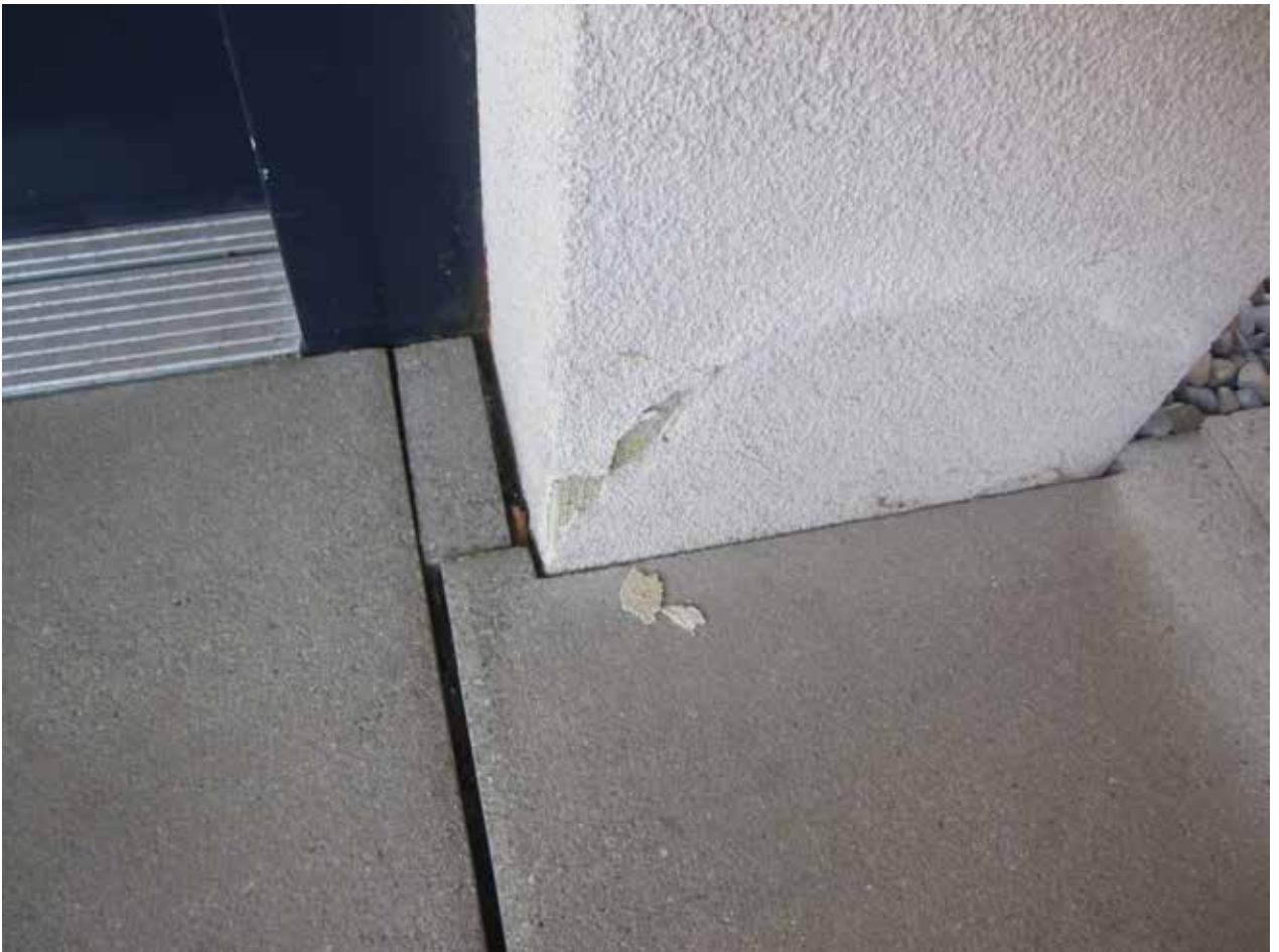
Putzschäden bei Liftschacht
