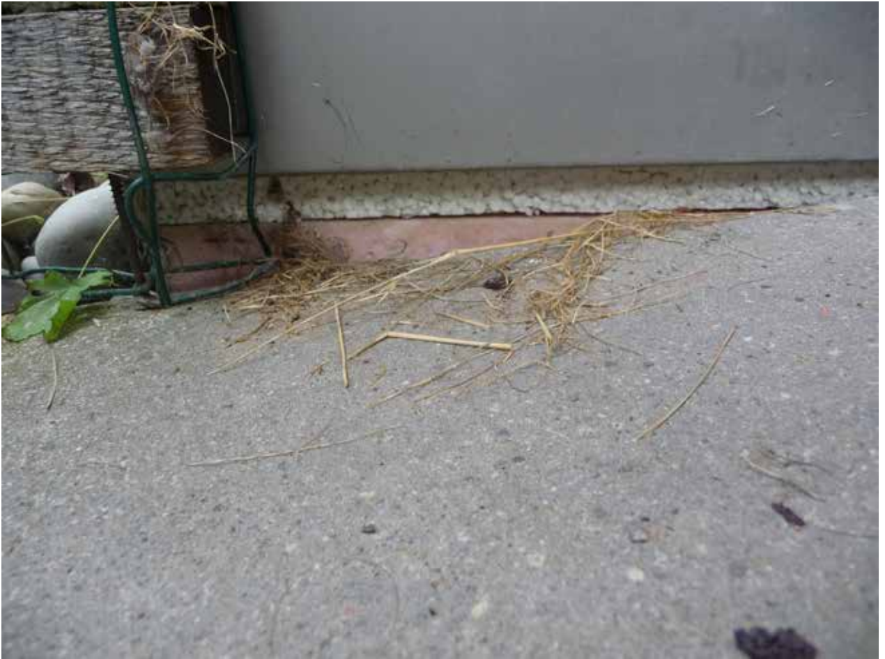
EG freiliegende EPS-Dämmung unter Sockelblech durch Setzungen Sitzplatz
