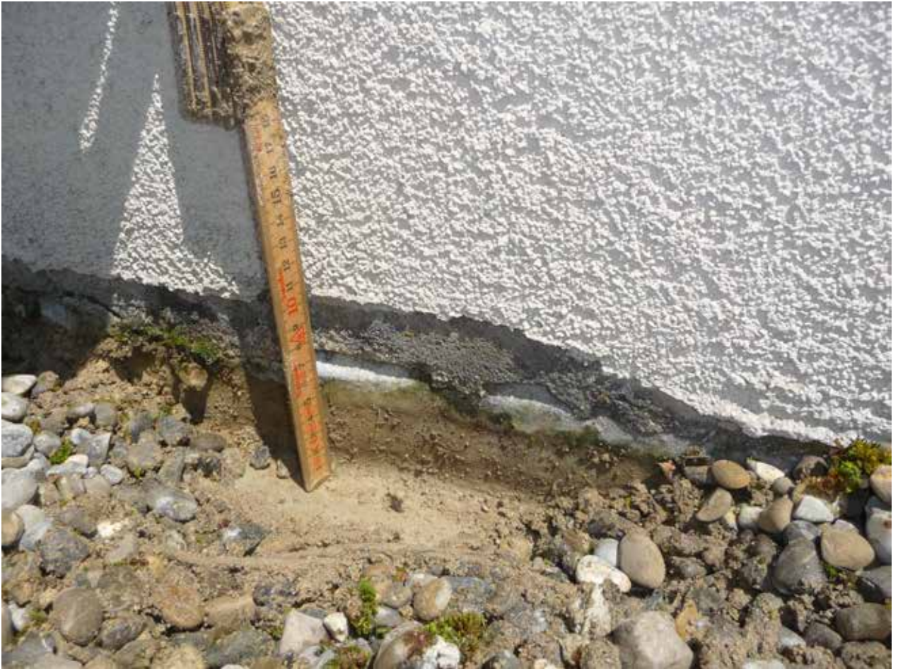
Putzschäden durch fehlende Sockelbleche bei Anschluss Liftüberfahrt bei allen Liegenschaften
