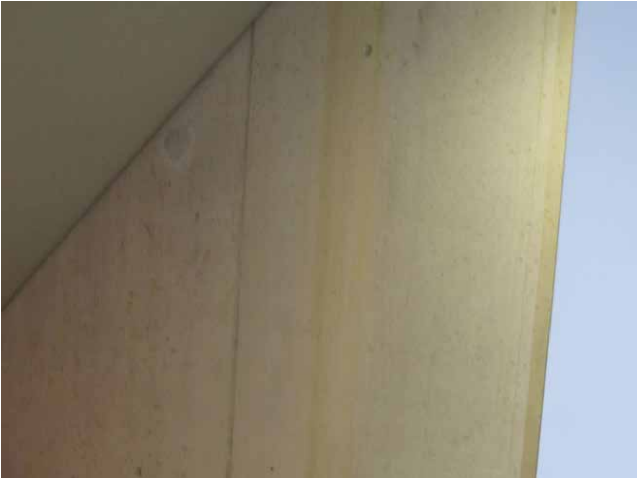
Wassereintritte UG unter Treppe
