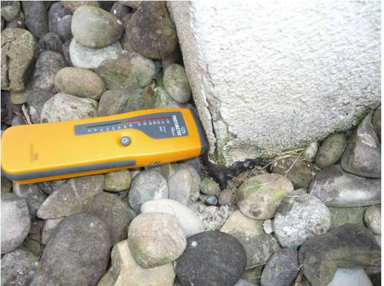
Putzschäden AWD bei Fassadenecke
