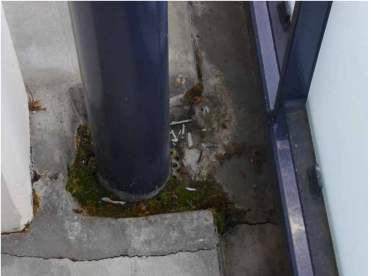
2.OG Risse Überzug bei Ablauf Balkon
