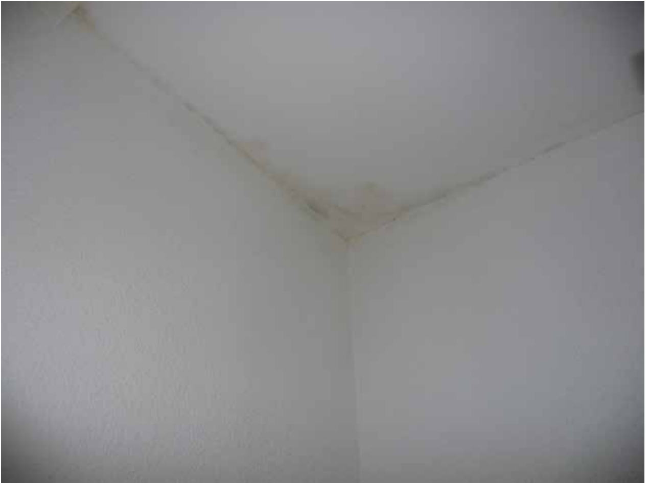
Wasserschaden Aussenecke gegen Laubengang. Warum?
