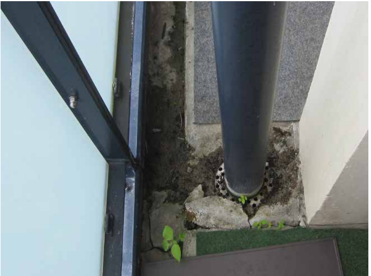
1.OG Risse Überzug bei Ablauf Balkon
