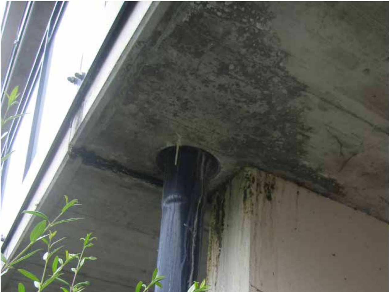
EG Risse Stirne und Untersicht Balkonplatte unter Ablauf Balkon (Schnäuze an Trennwand)
