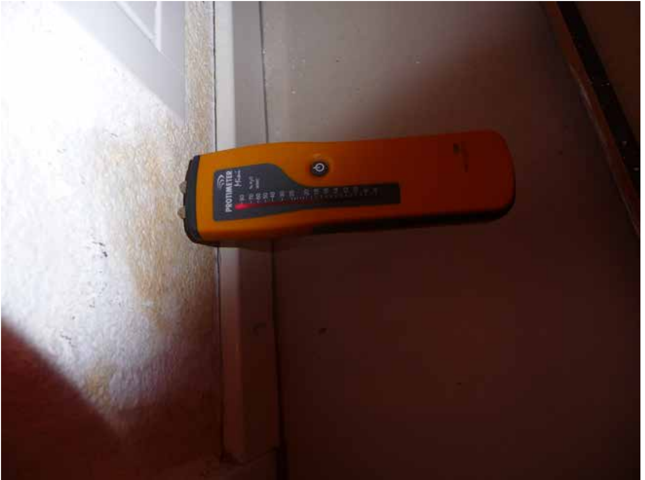
Wasserschaden bei UV Bodenheizung im Entree
