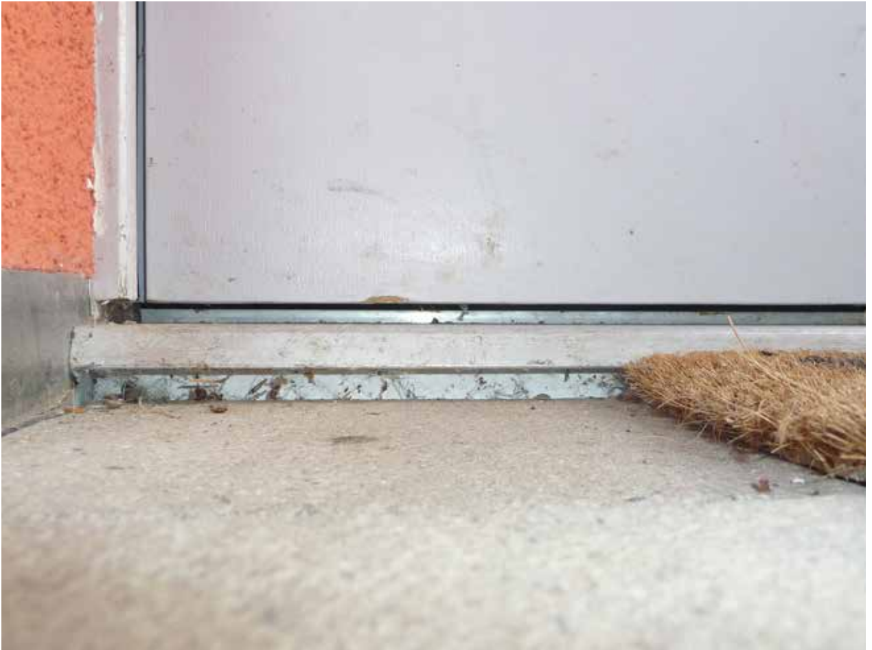
EG Offene Fuge unter Wetterschenkel Wohnungstüre
