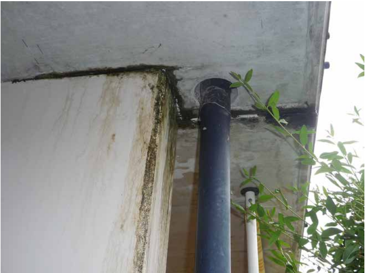
EG Risse Balkonuntersicht bei Ablauf Balkon (Schnäuze an Trennwand)
