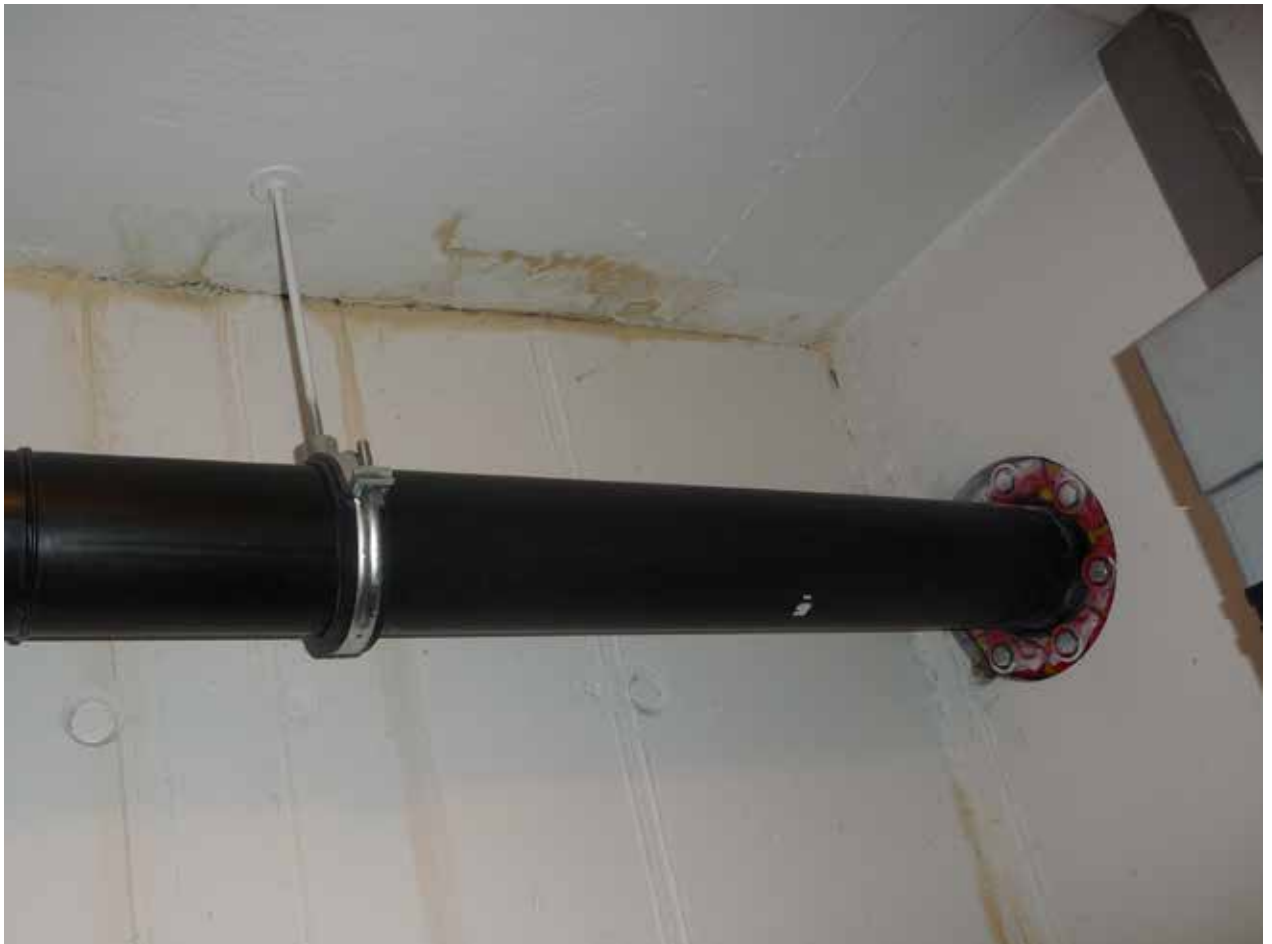
Wassereintritte in Waschküche
