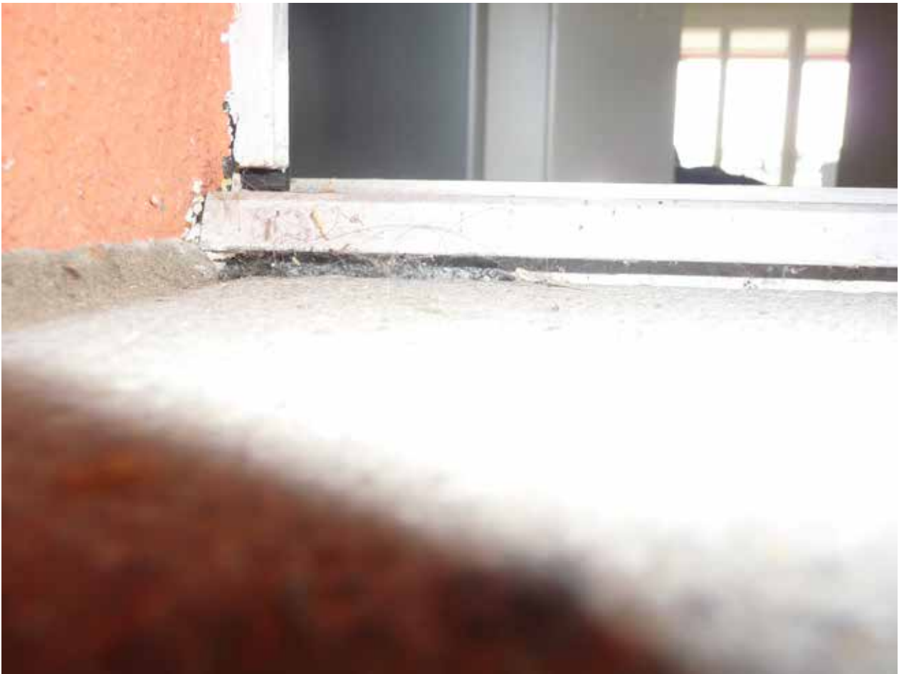
2.OG Offene Fuge unter Wetterschenkel Wohnungstüre
