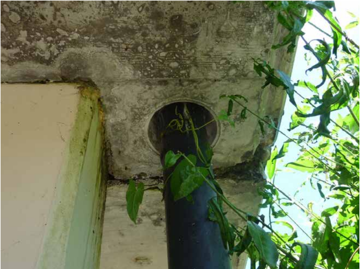
EG Risse und Feuchtigkeit in Balkonplatte unter Ablauf Balkon
