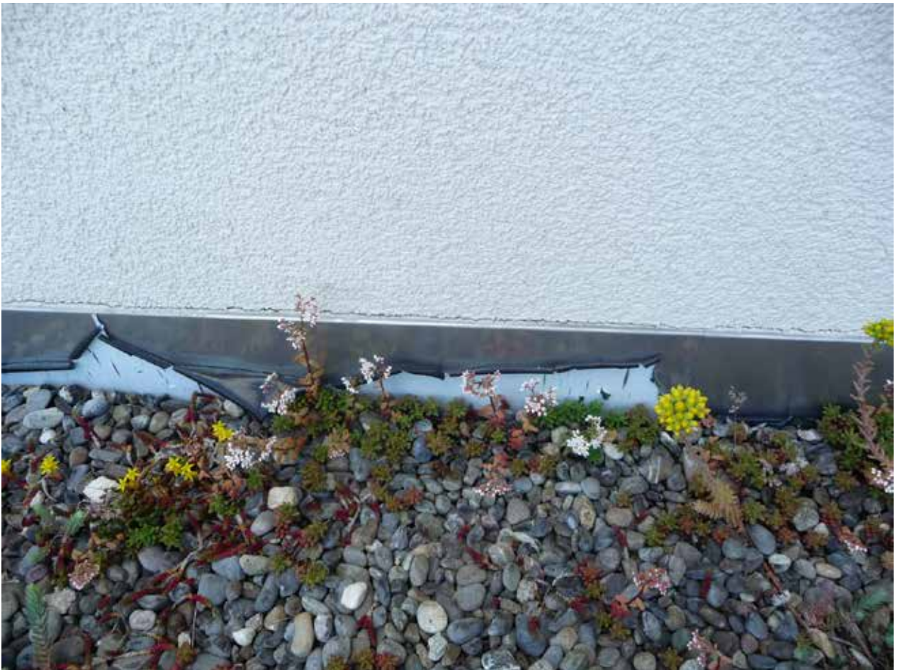
Risse über Sockelblech bei Anschluss AWD an Flachdach
