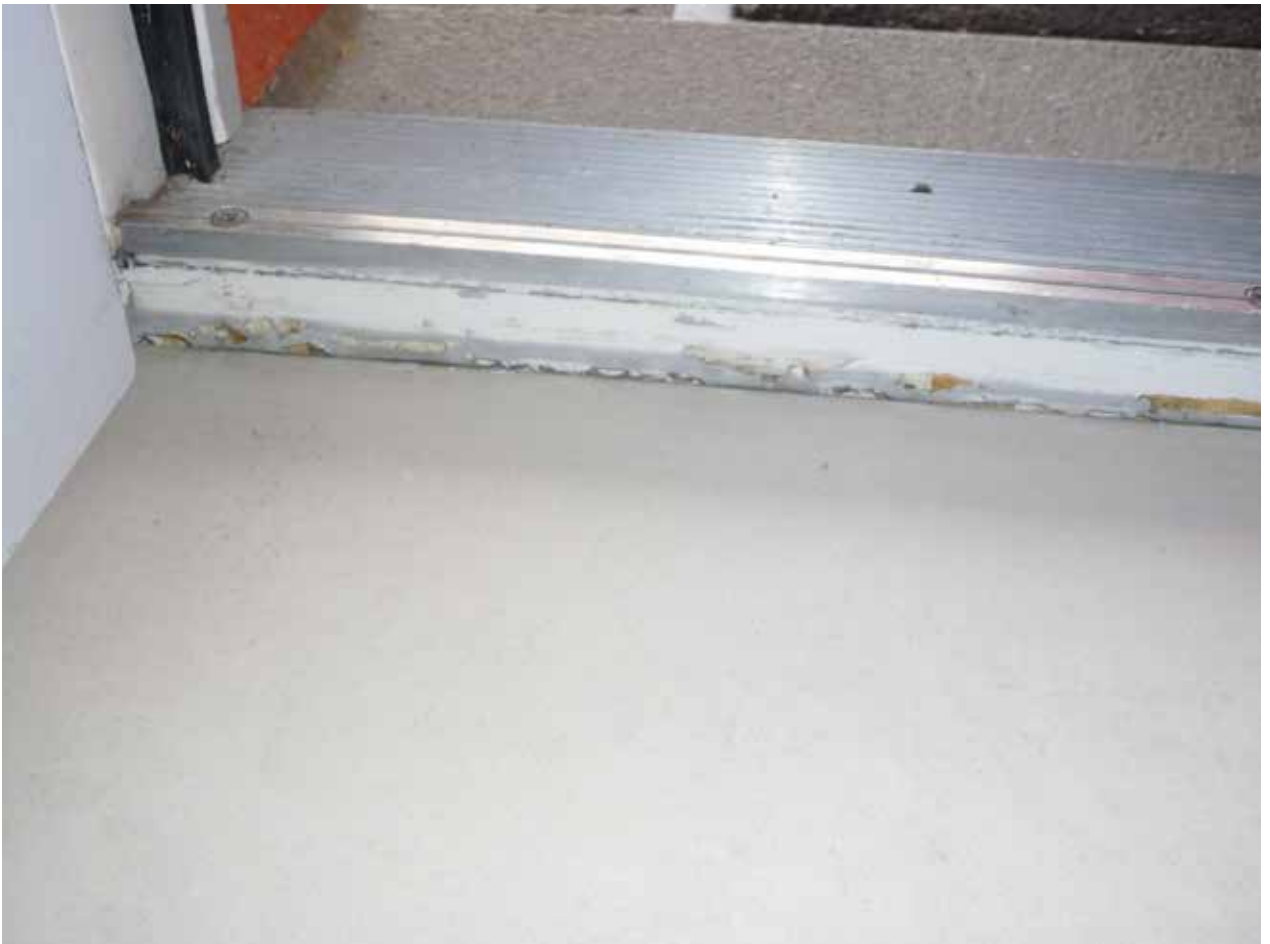
1.OG Gerissene Fuge bei Schwelle Wohnungstüre
