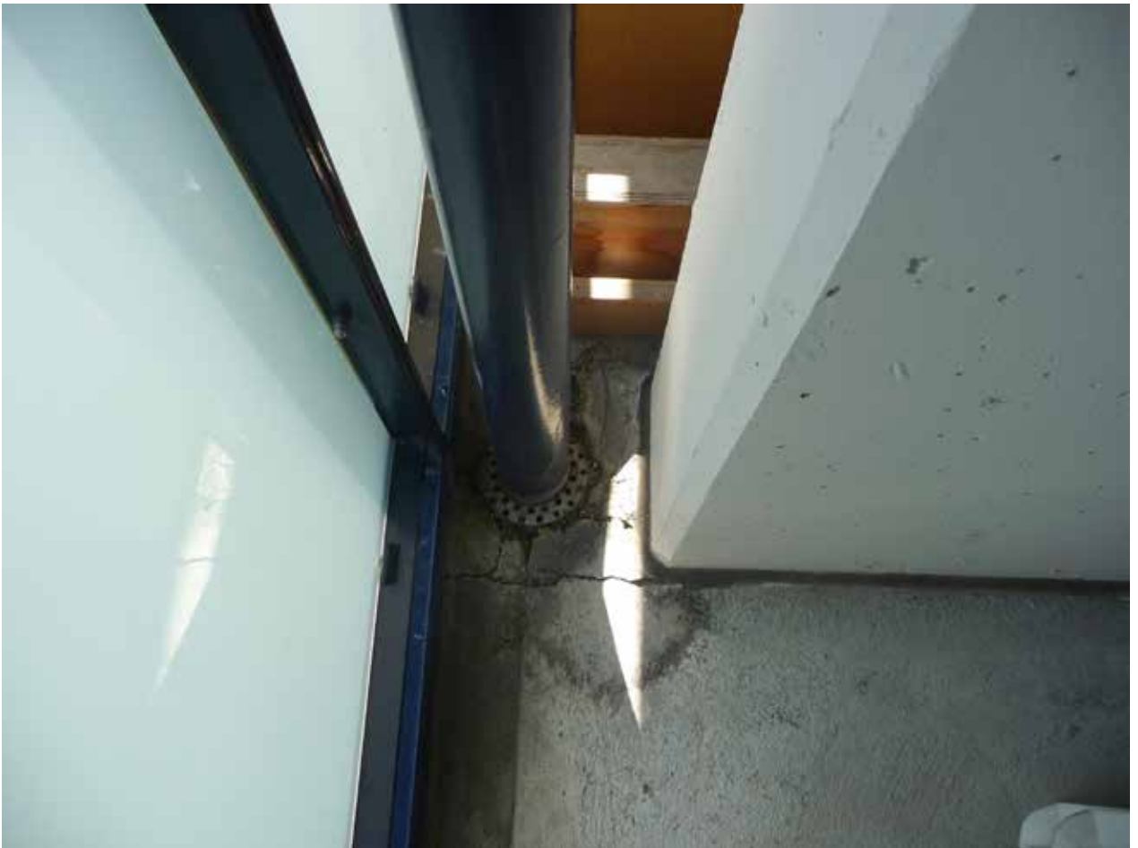
2.OG Risse Überzug bei Ablauf Balkon
