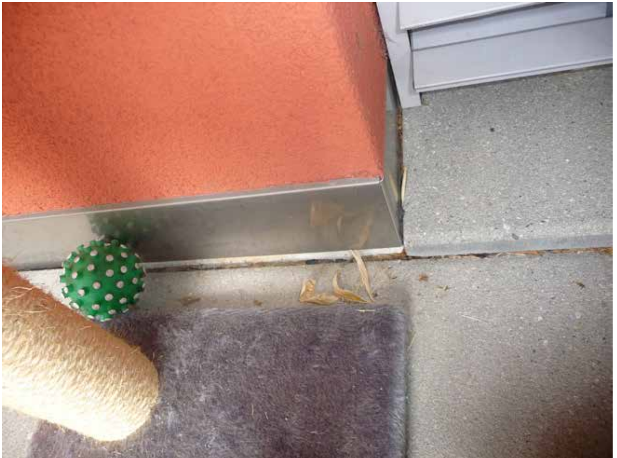
Freiliegende EPS Dämmung unter Sockelblech durch Setzungen Sitzplatz
