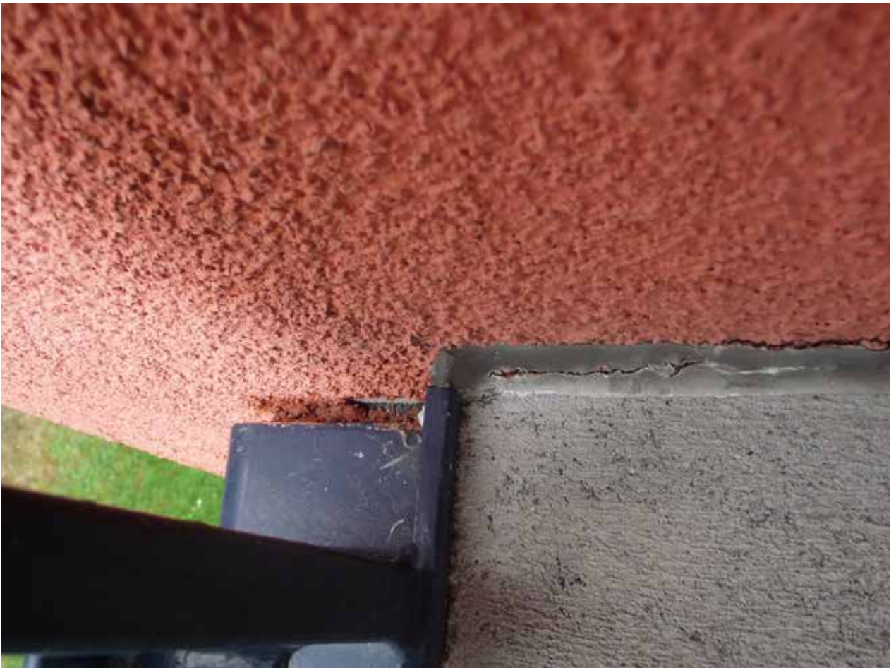
2.OG Offene Fuge Anschluss Balkon
