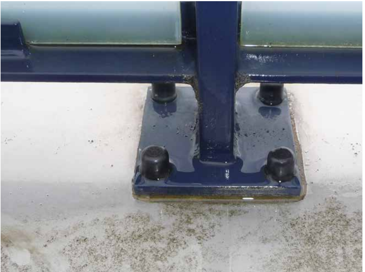
DG stehendes Wasser auf Dachrandblechen (Ersatz Fugen Geländerpfosten) bei allen Liegenschaften
