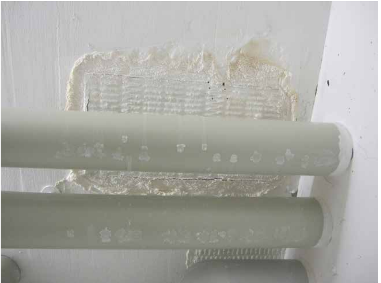
Wassereintritte UG durch Abschottungen Steigzone (Wasser woher?)
