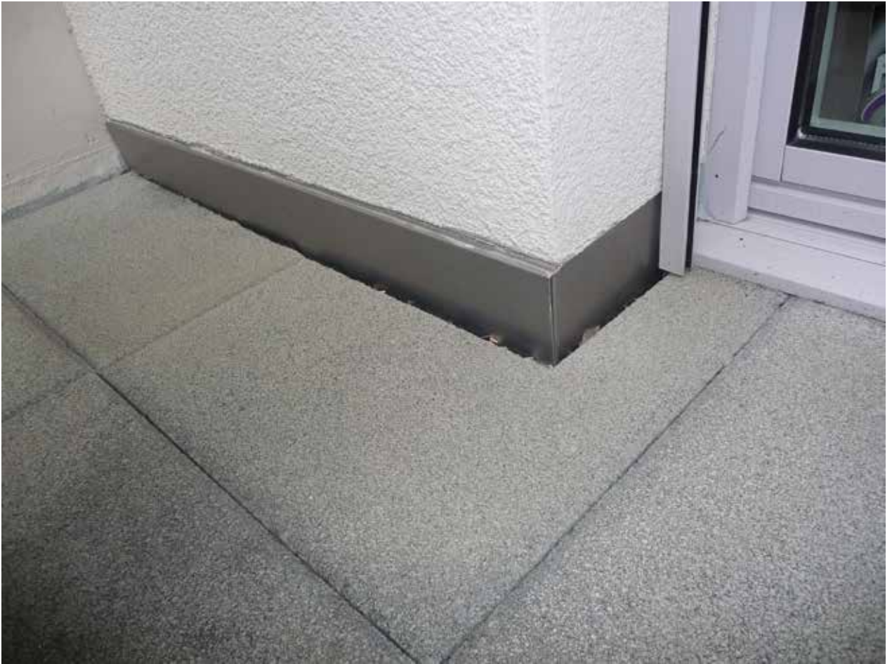
DG Risse,- Ablösungen Sockelblech
