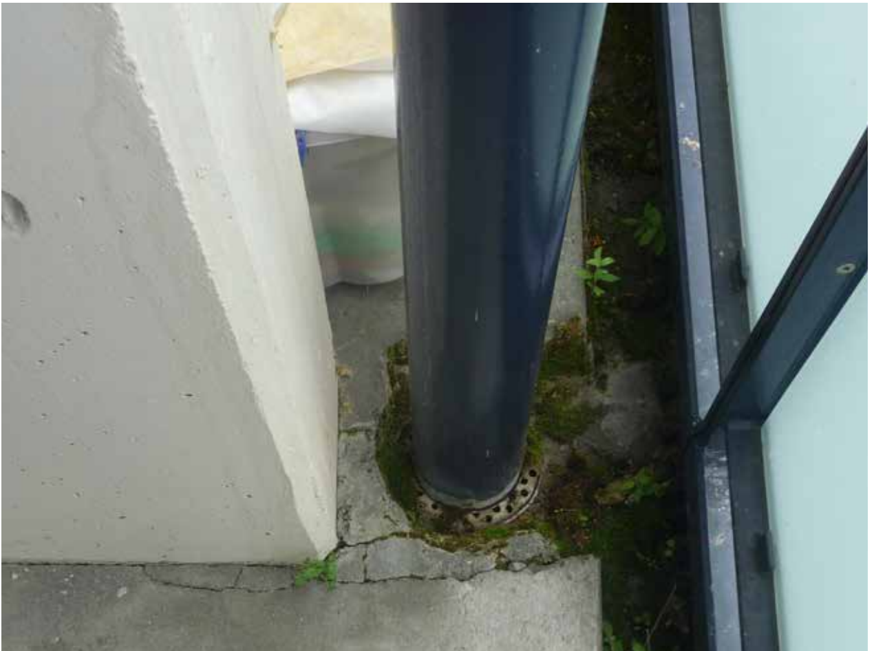
1.OG Risse Überzug bei Ablauf Balkon
