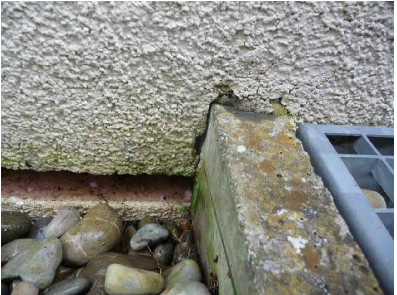
Setzung Dämmplatten Spalt bei Übergang ins Erdreich (Kältebrücke)
