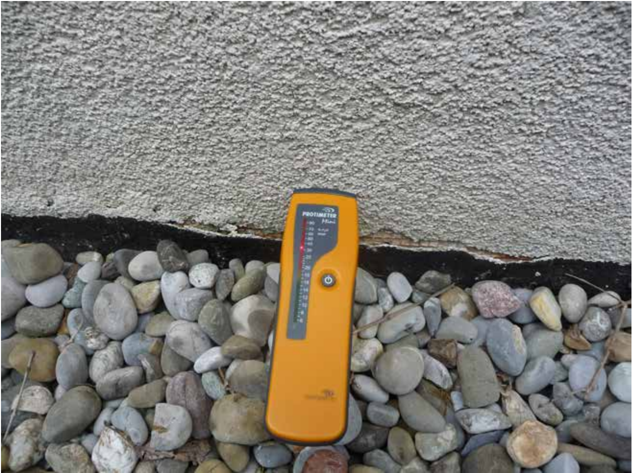
Putzschäden AWD bei Fassadensockel
