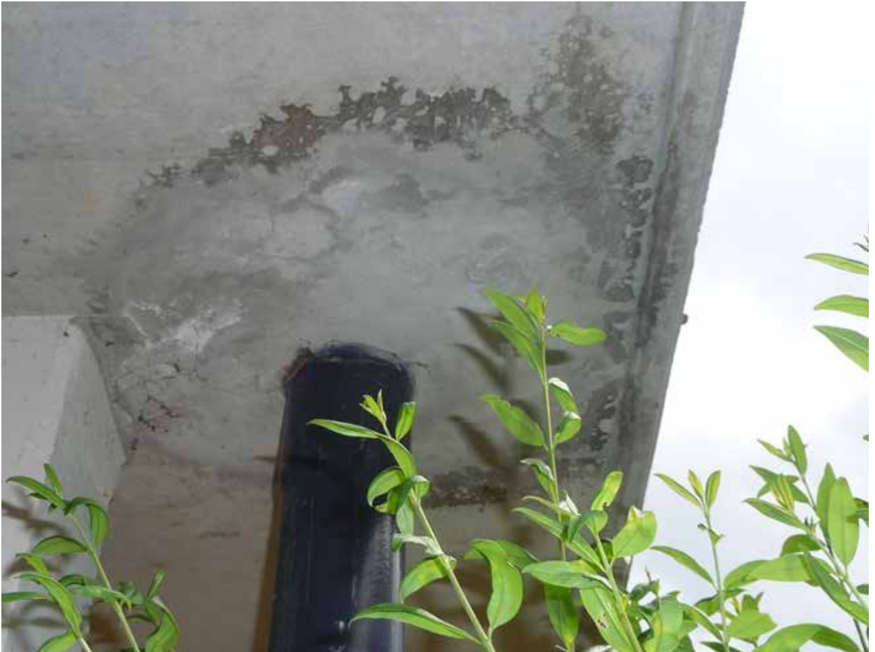
EG Eindringendes Wasser in Balkonplatte bei Ablauf Balkon
