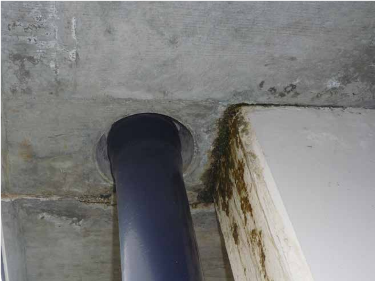
1.OG Risse Balkonplatte unter Ablauf Balkon
