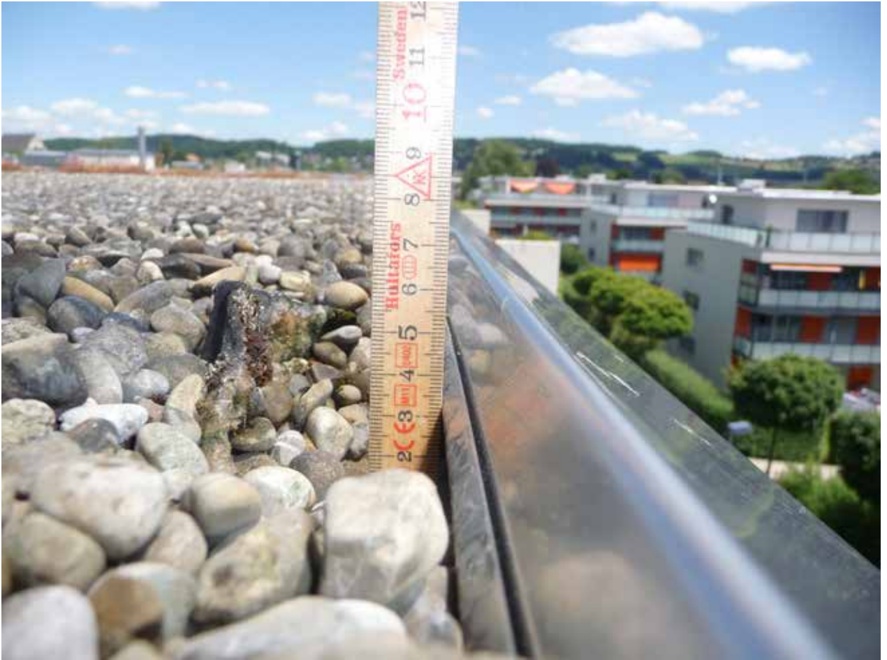
ungenügende Dachrandhöhe führt zu Kiesverfrachtungen auf darunterliegende Dachterrasse, Wasser über Dachrand bei Gewitter (Problem Fassade)
