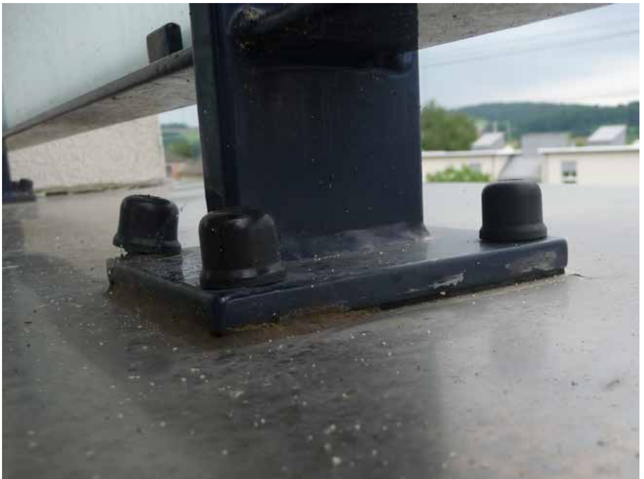
offene Fuge unter Geländerpfosten und Kronenabdeckblech
