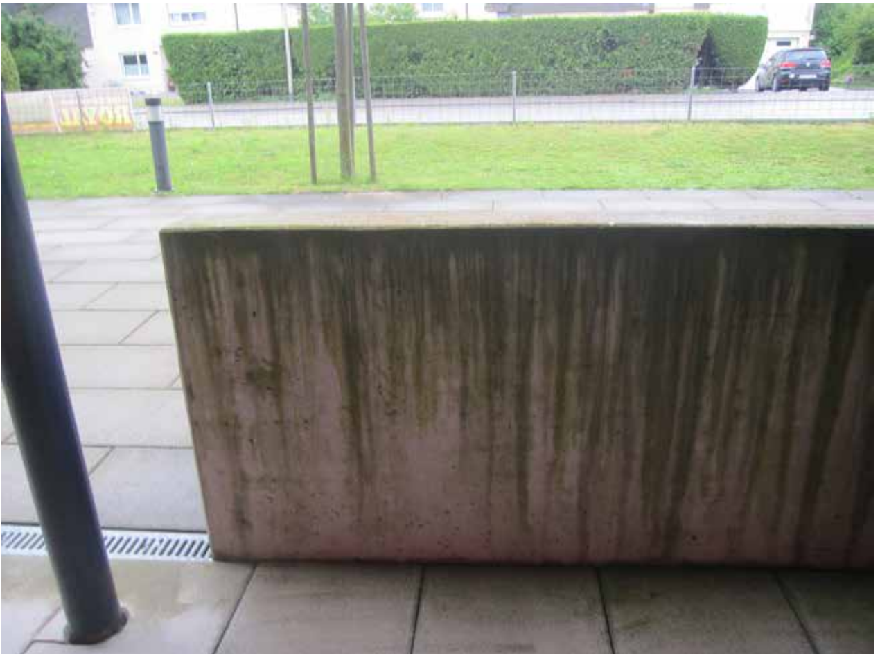
EG fehlende Mauerabdeckung Brüstung Treppe
