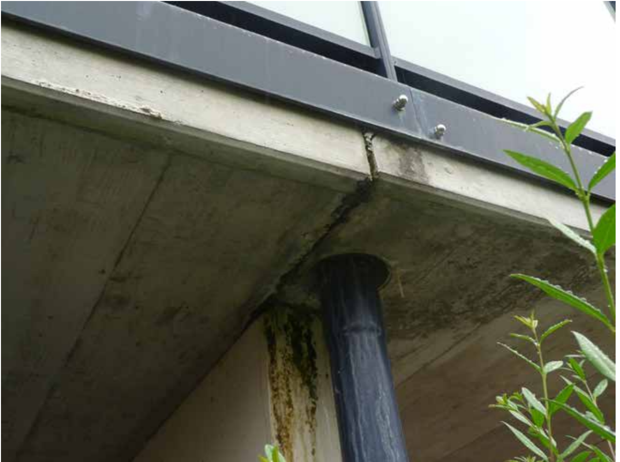
EG Risse Balkonstirne bei Ablauf Balkon
