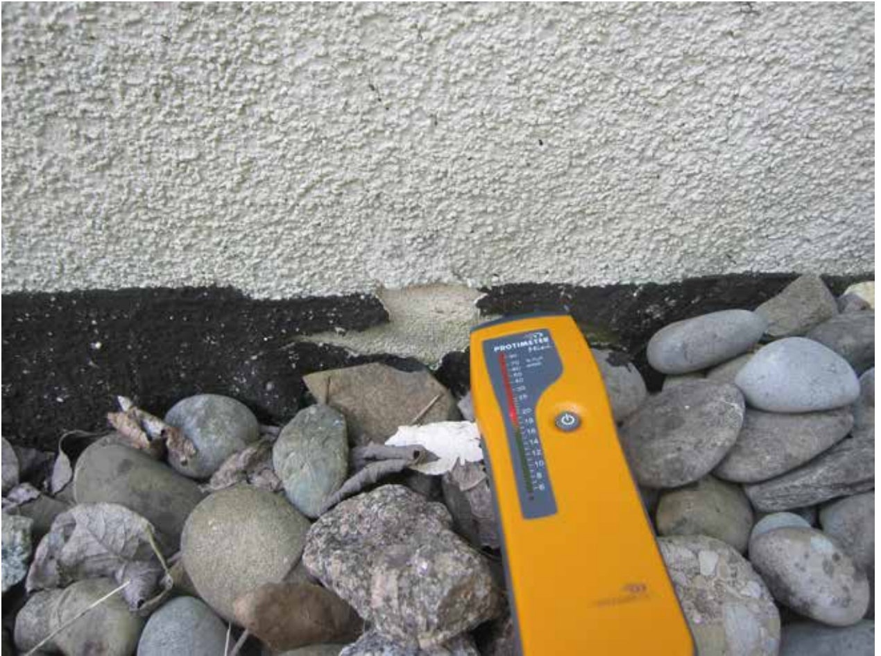
Putzschäden AWD bei Sockel
