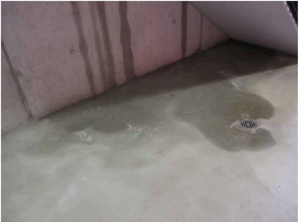
Wassereintritte UG unter Treppe
