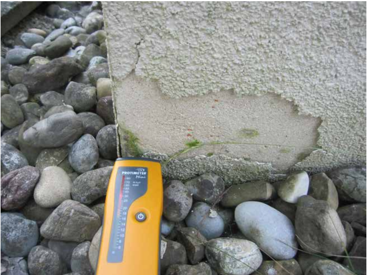
Putzschäden AWD bei Sockel
