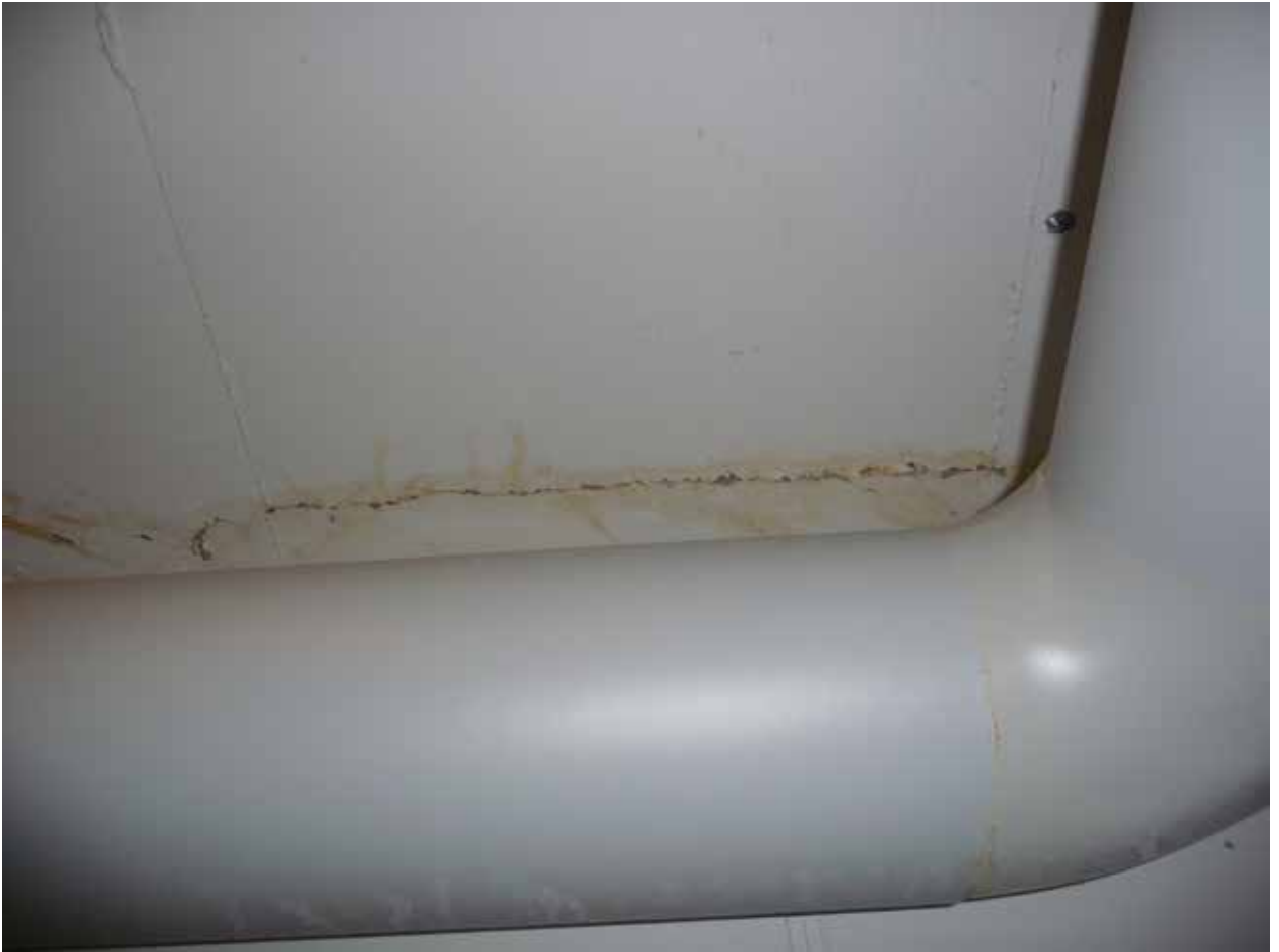
Wassereintritte UG Trockenraum unter Liftschach
