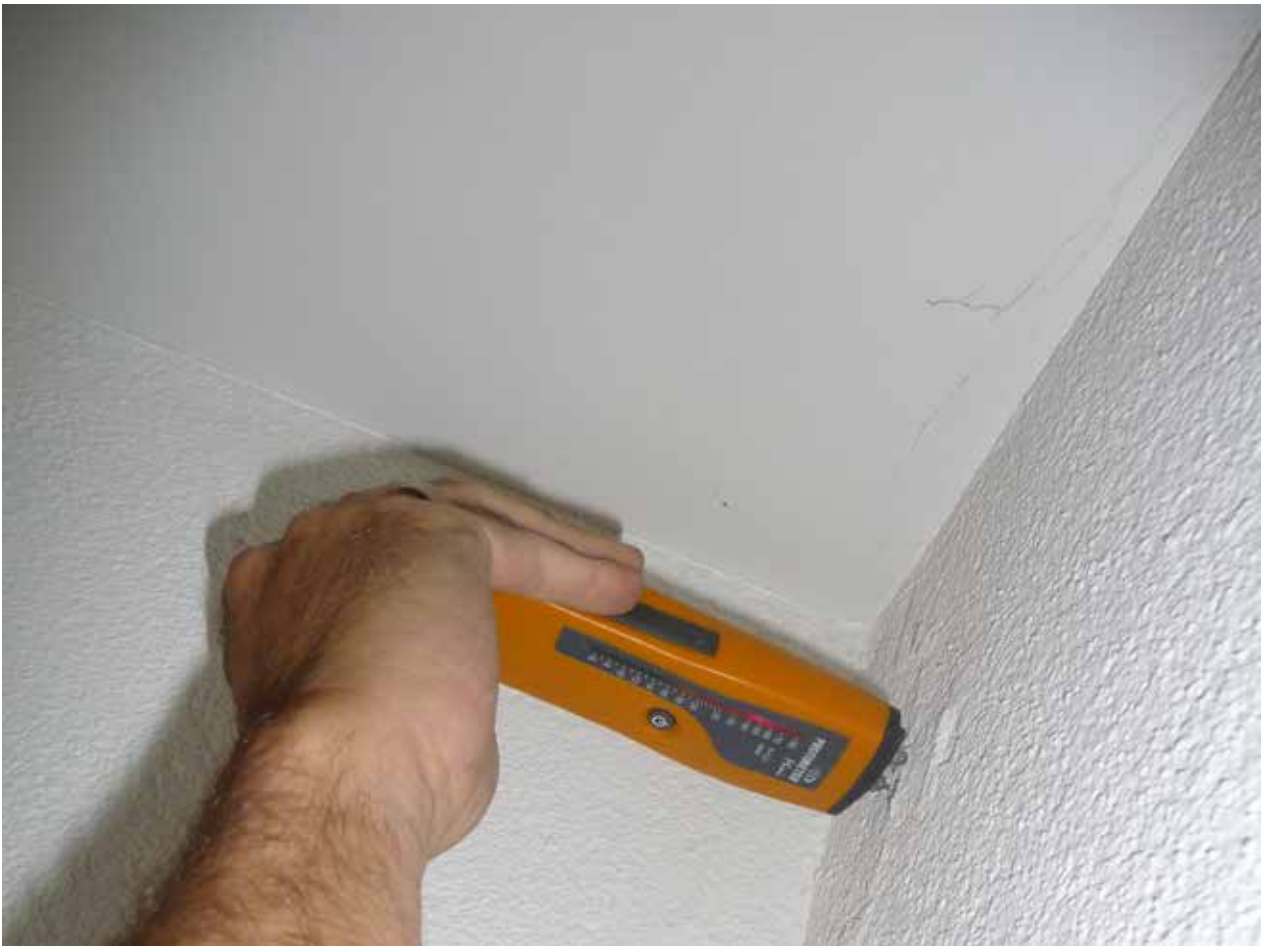
Wasserschaden Aussenecke gegen Laubengang Zimmer 4. Warum?
