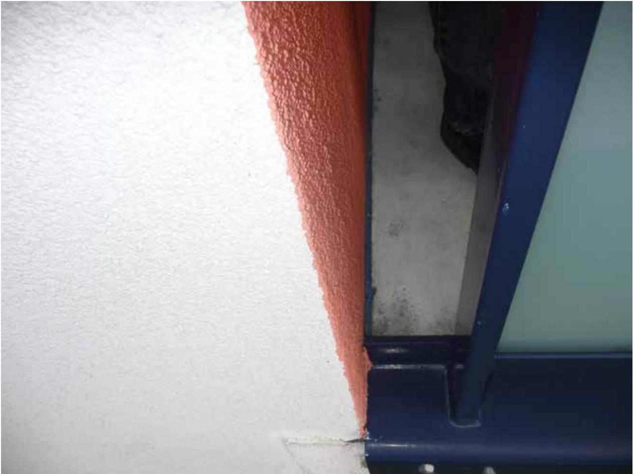
2.OG Putzschäden bei Anschluss Balkonplatte an AWD
