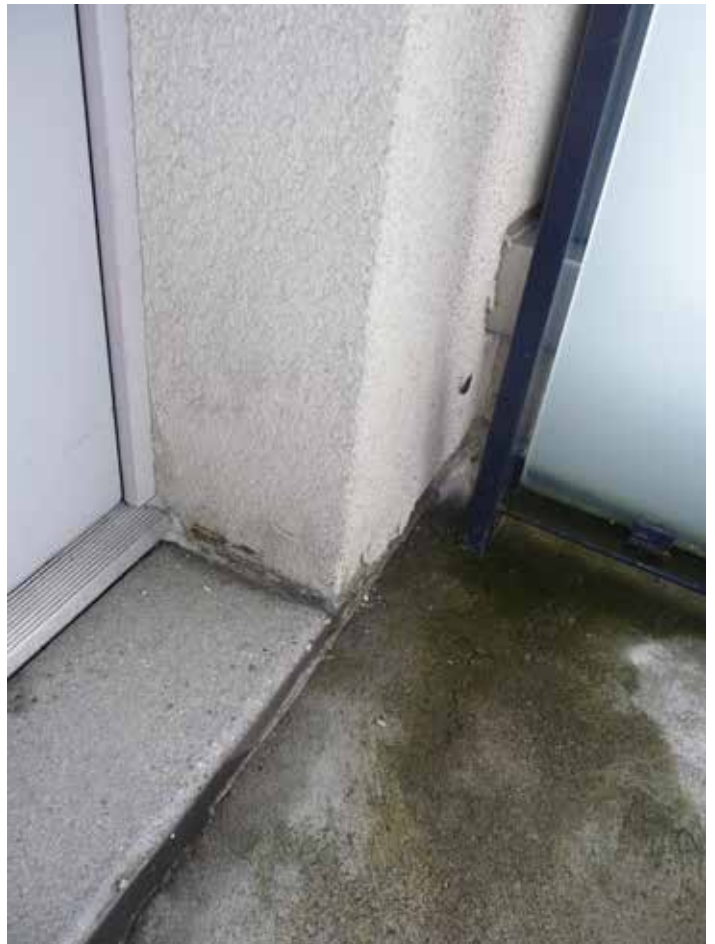
DG Putzschäden bei Anschluss Laubengang an AWD (hohe Feuchtigkeit in Laubengangplatte)
