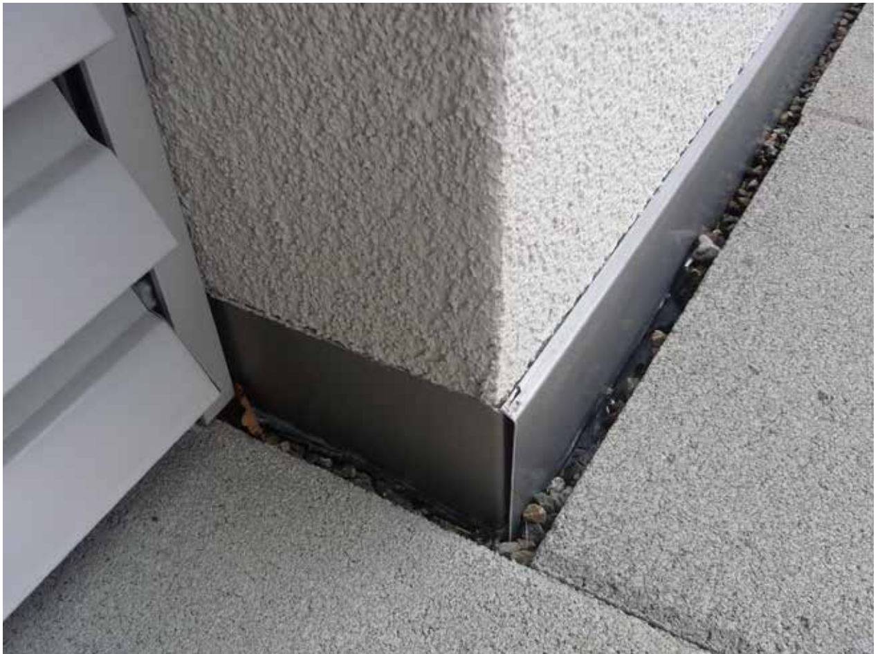
DG Risse über Sockelblech
