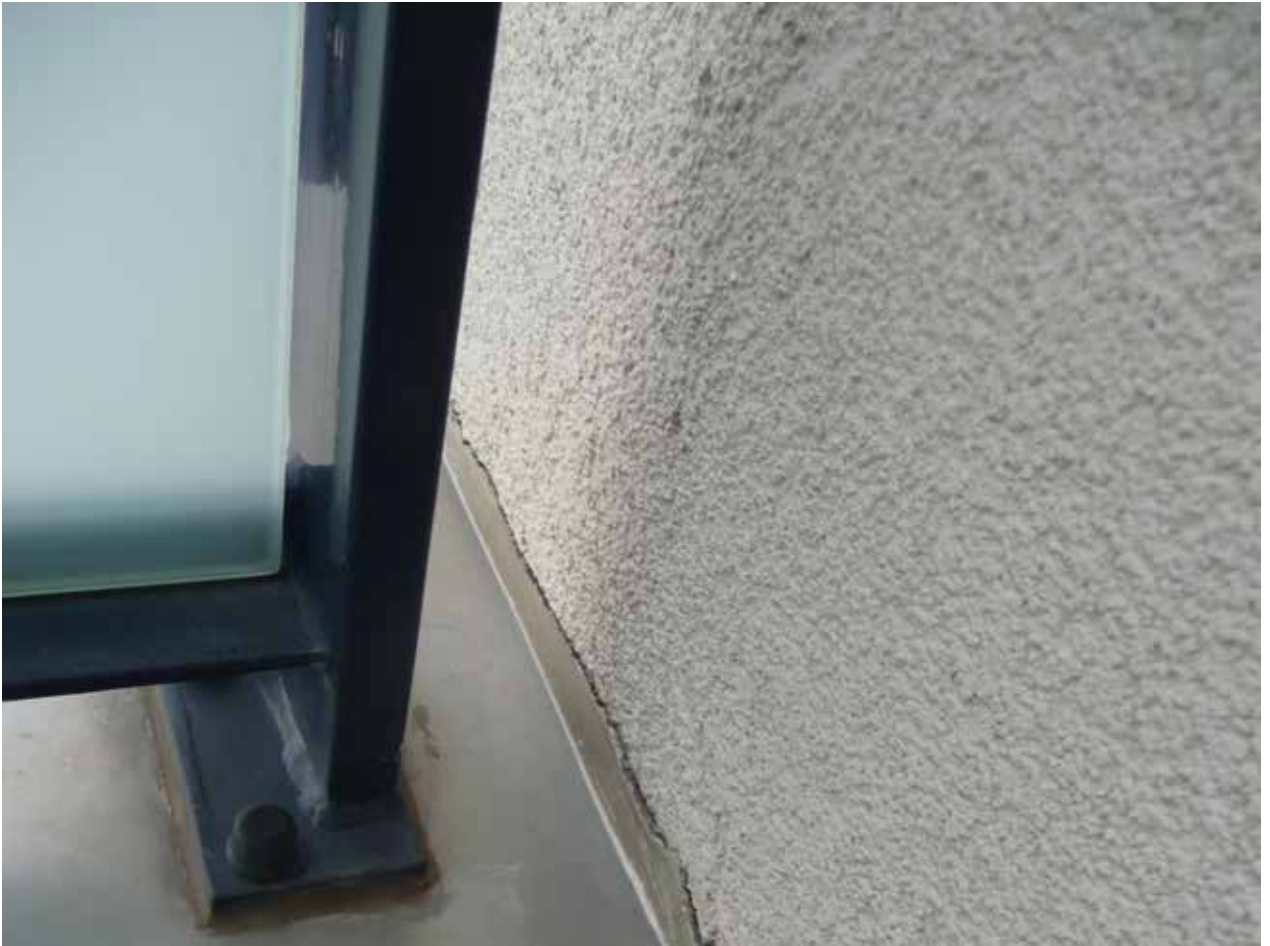
DG Offene Fuge bei Anschluss Dachrandabschluss an AWD (kein Putzbord)
