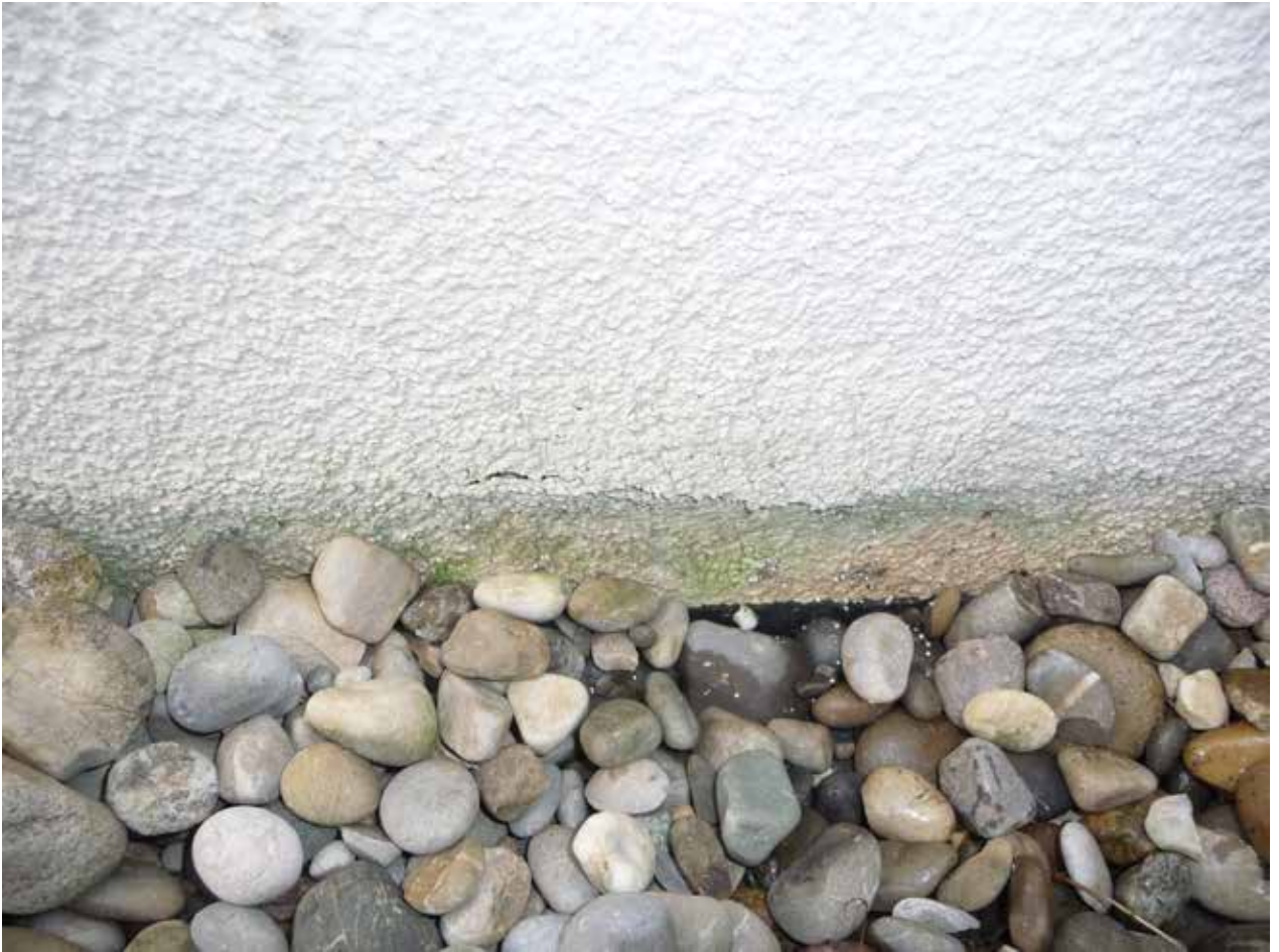
Putzschäden AWD bei Fassadensockel
