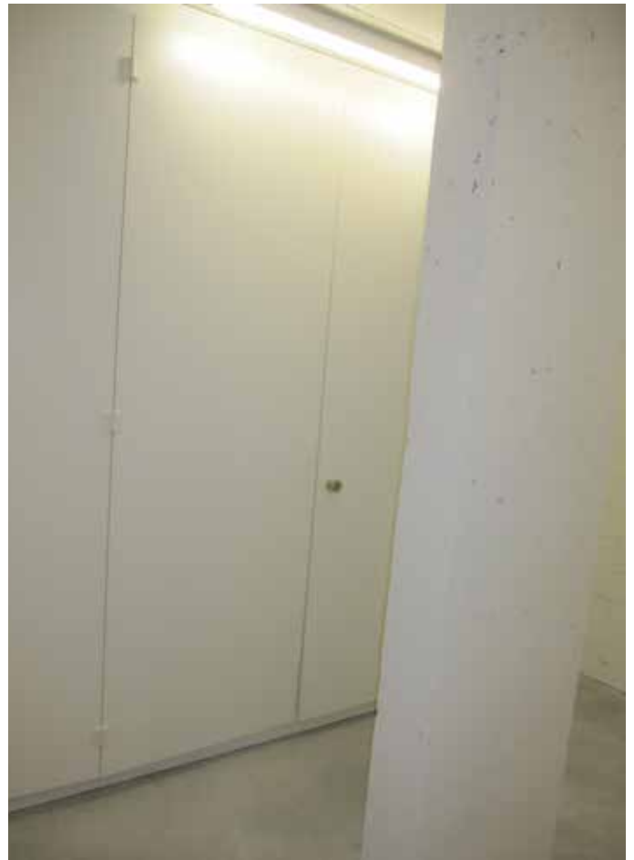
Verzogene Türen HV durch Feuchtigkeit
