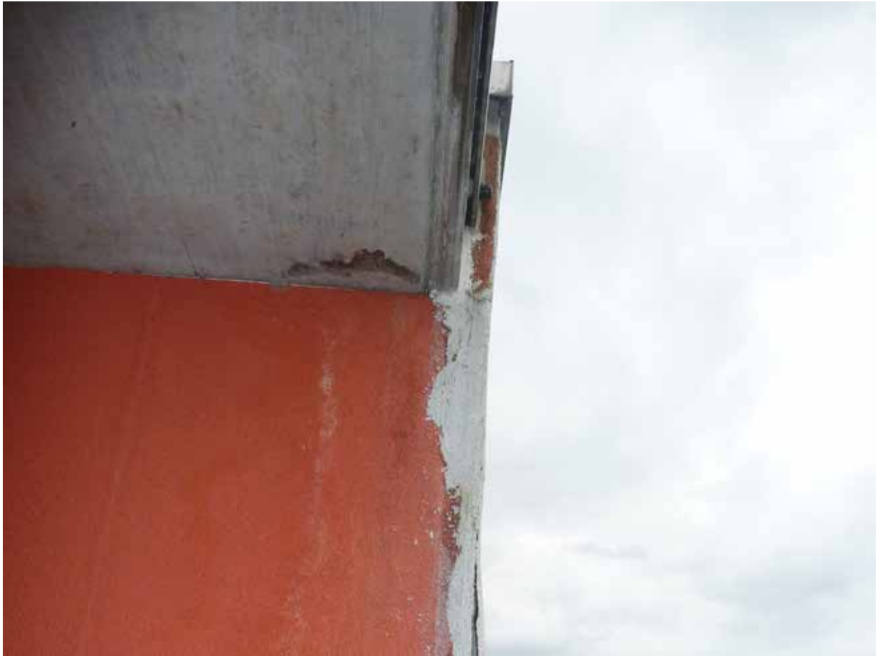
2.OG Putzschäden bei Anschlüsse Laubengang an AWD
