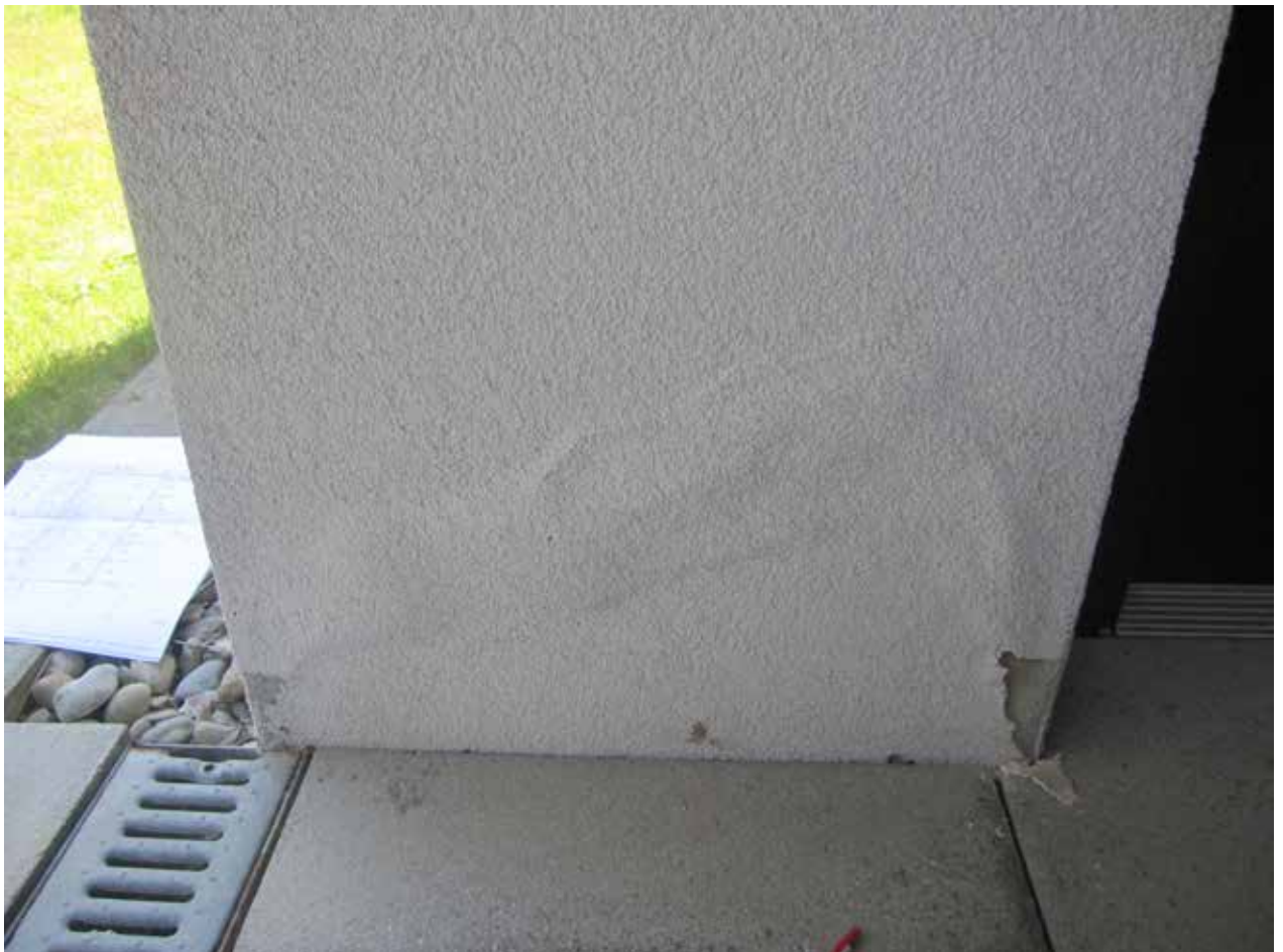
Im Nippel 5 - Putzschäden bei Liftschacht
