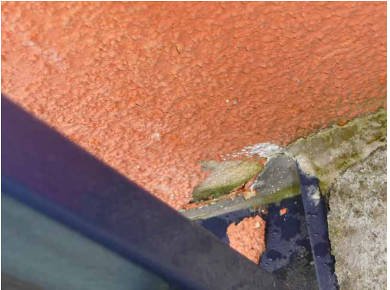
2.OG Putzschäden Anschluss AWD an Laubengang
