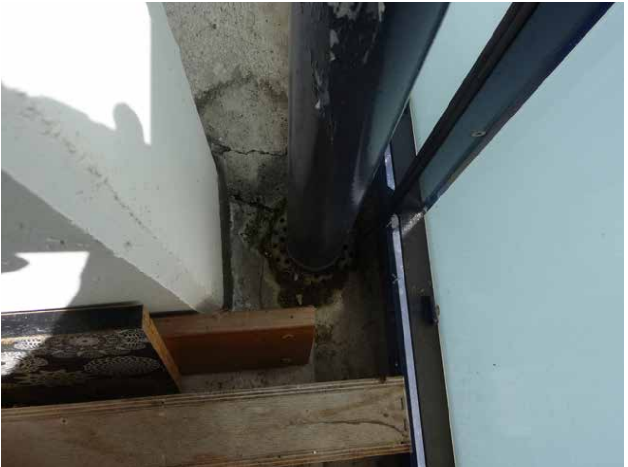
2.OG Risse Überzug bei Ablauf Balkon
