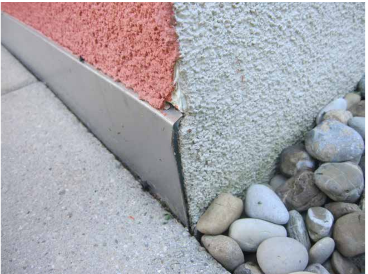
Ablösung Sockelbleche, Putzschäden gegen Sitzplatz
