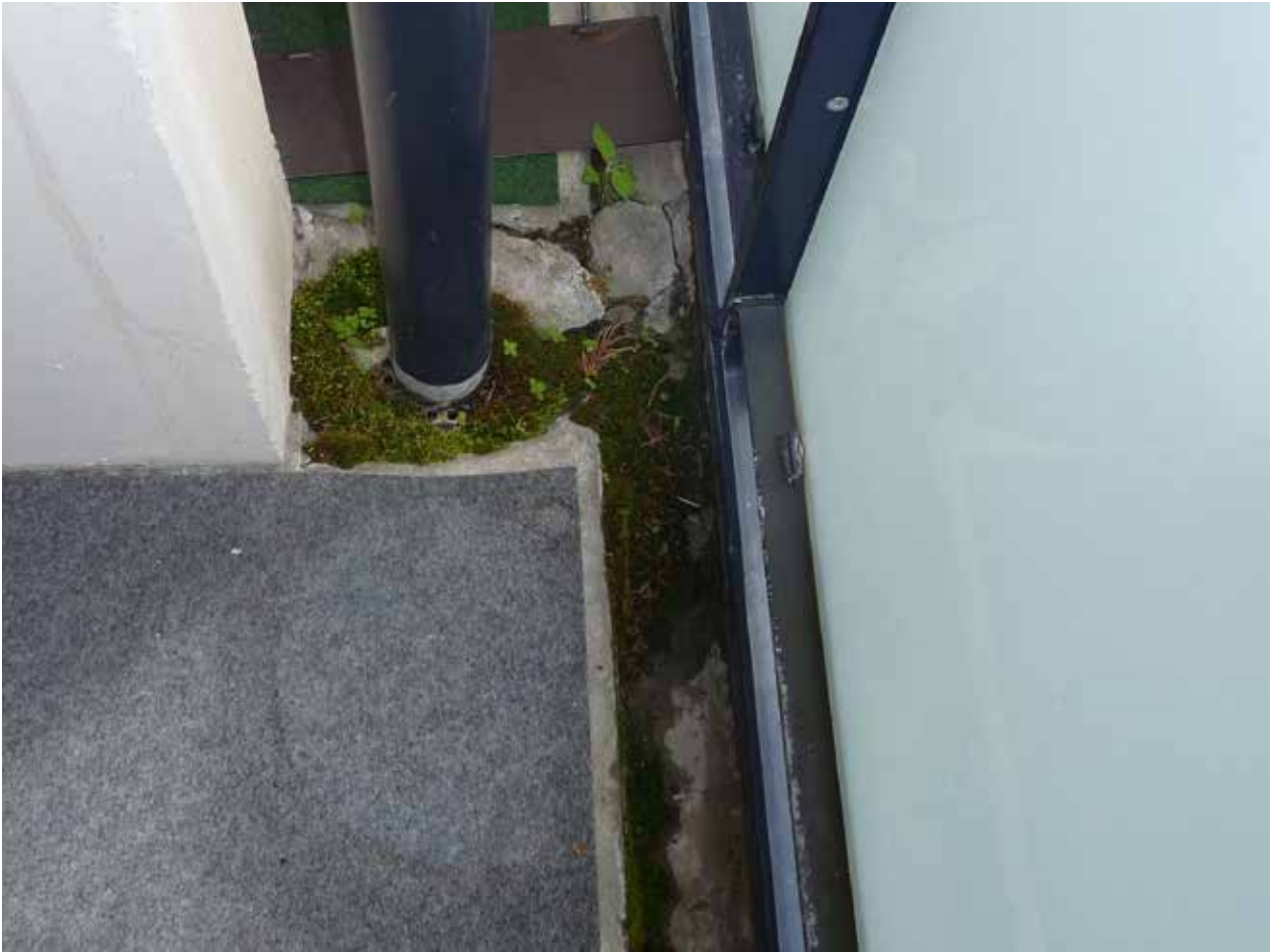
1.OG Risse Überzug, Zugewachsener Ablauf Balkon
