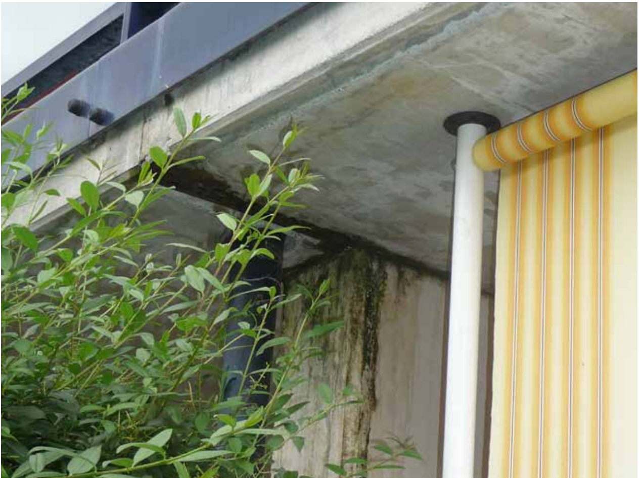
EG Risse Balkonplatte, Untersicht und Stirne unter Ablauf Balkon (Schnäuze an Trennwand)
