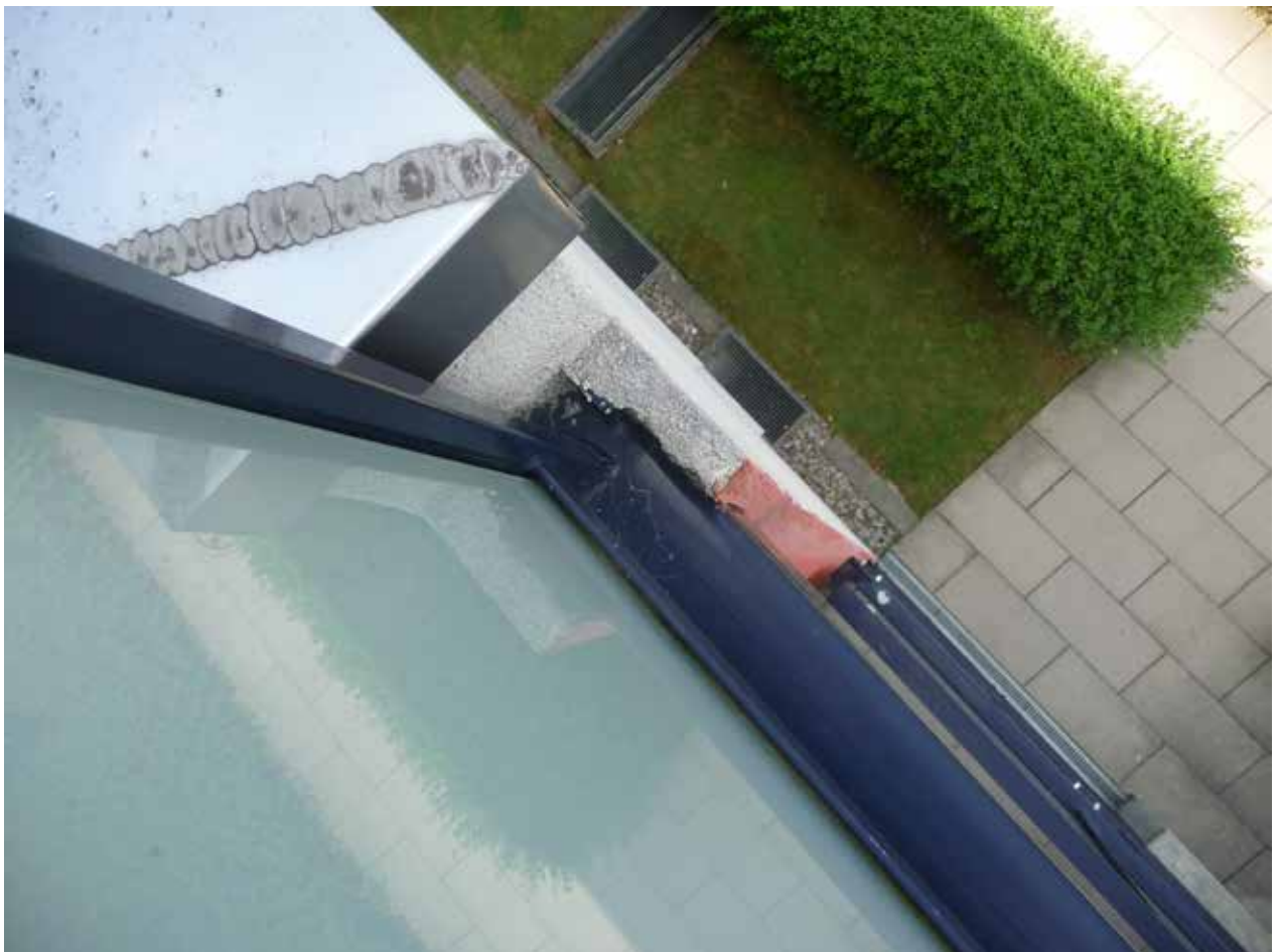
DG Fehlende Abdeckbleche bei Übergang Laubengang an AWD
