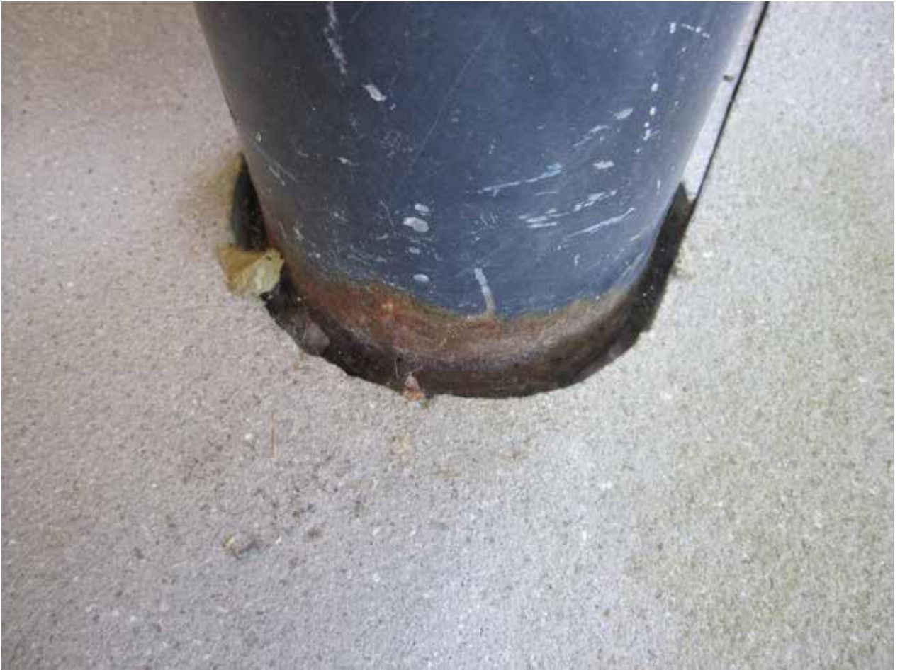
rostige Stützenfüsse Laubengänge
