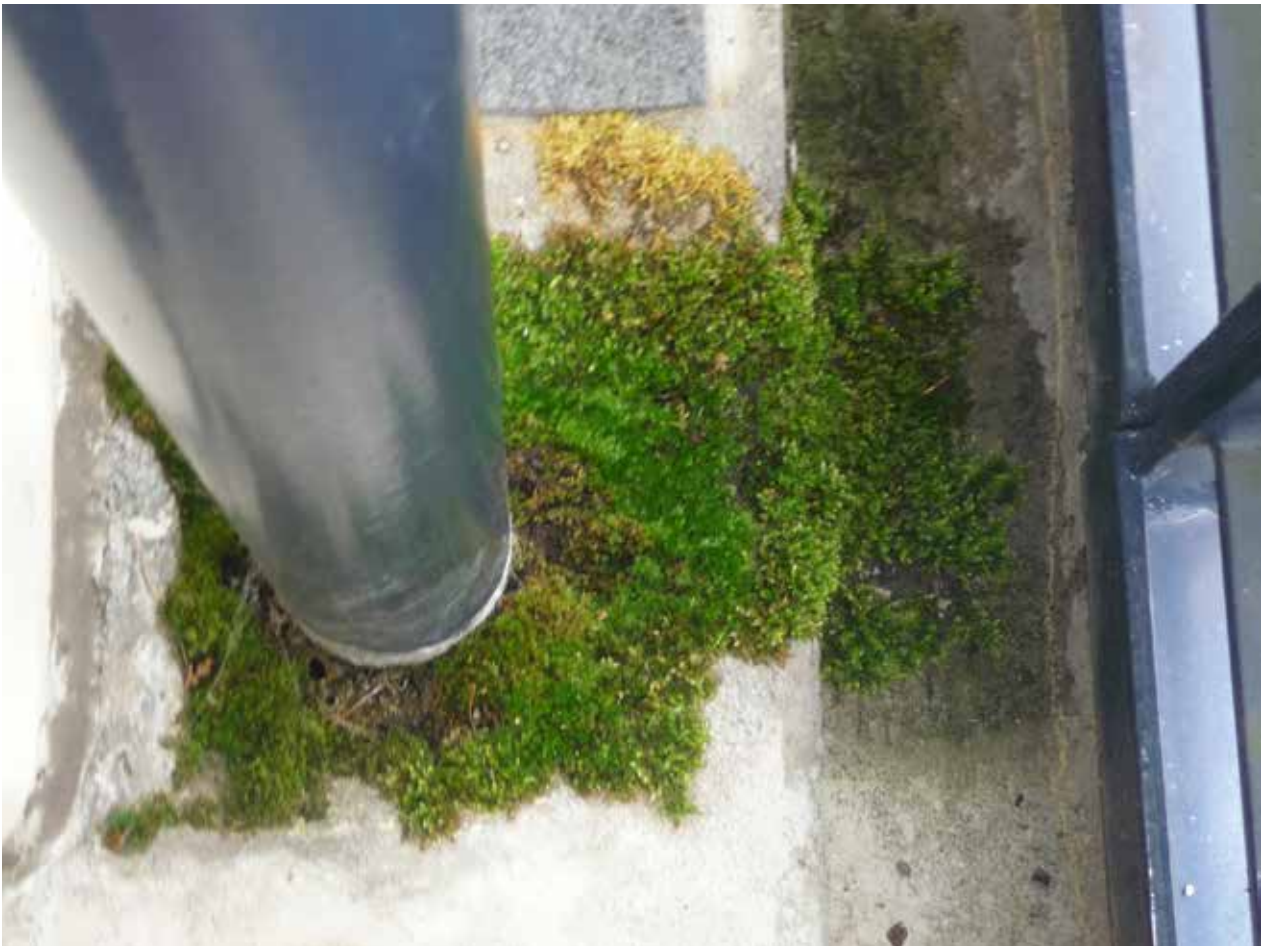
1.OG zugewachsener bei Ablauf Balkon
