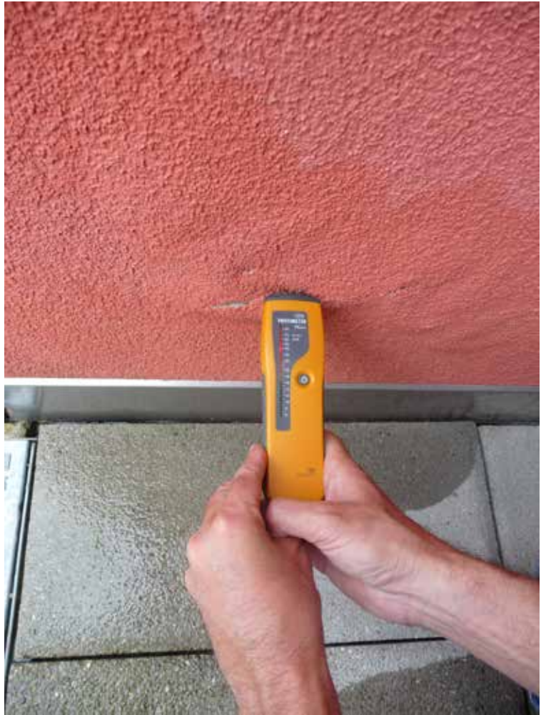
Putzschäden AWD über Sockelblech Eingangsbereich
