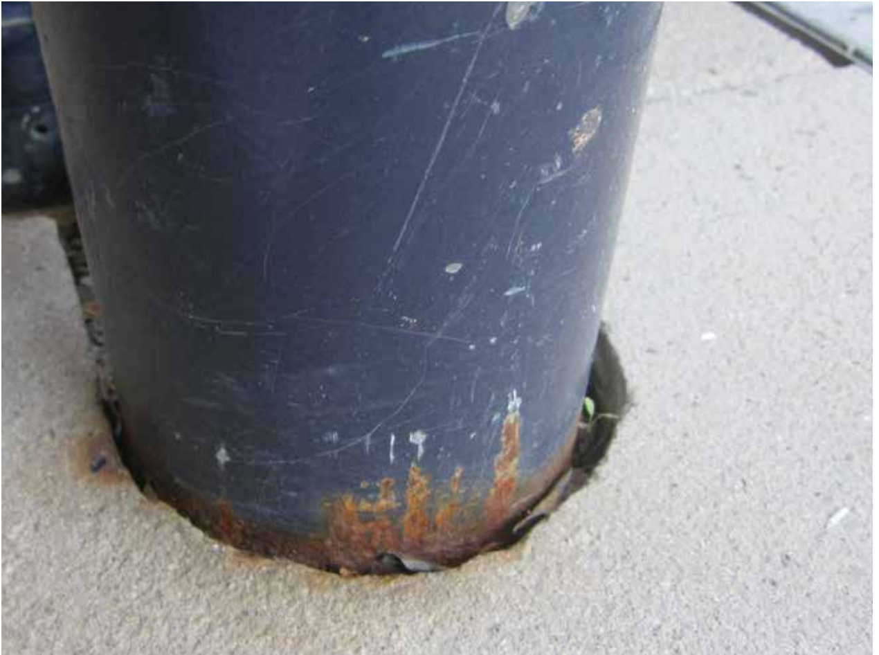
EG rostige Stützenfüsse Laubengang
