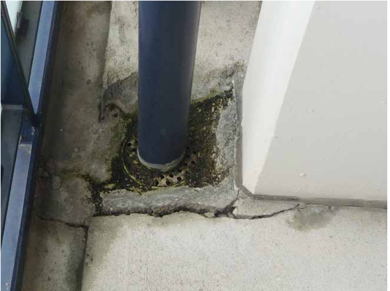
Risse Überzug bei Ablauf Balkon
