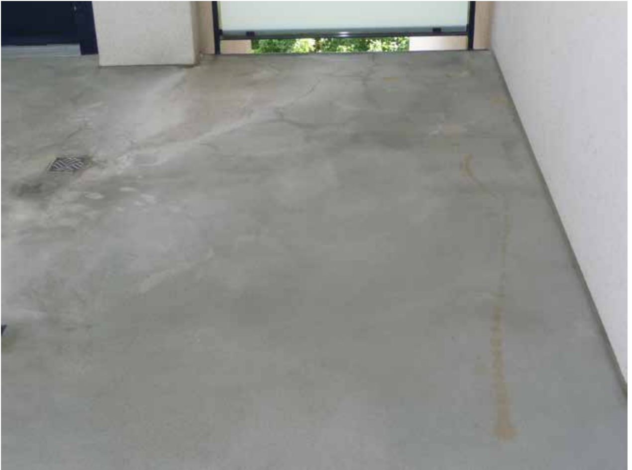
DG Feuchtigkeit und Risse in Bodenplatte Laubengang (Gefälle?)
