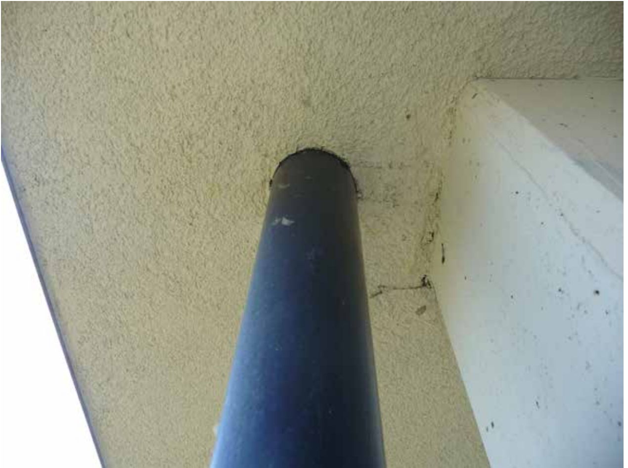
2.OG Putzschäden Untersicht Balkon bei Anschluss Stütze an AWD
