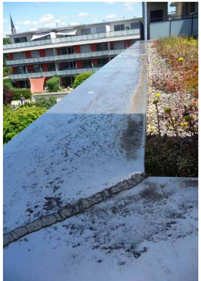
Korrosion Kronenabdeckbleche durch stehendes Wasser(Zuwenig Gefälle)
