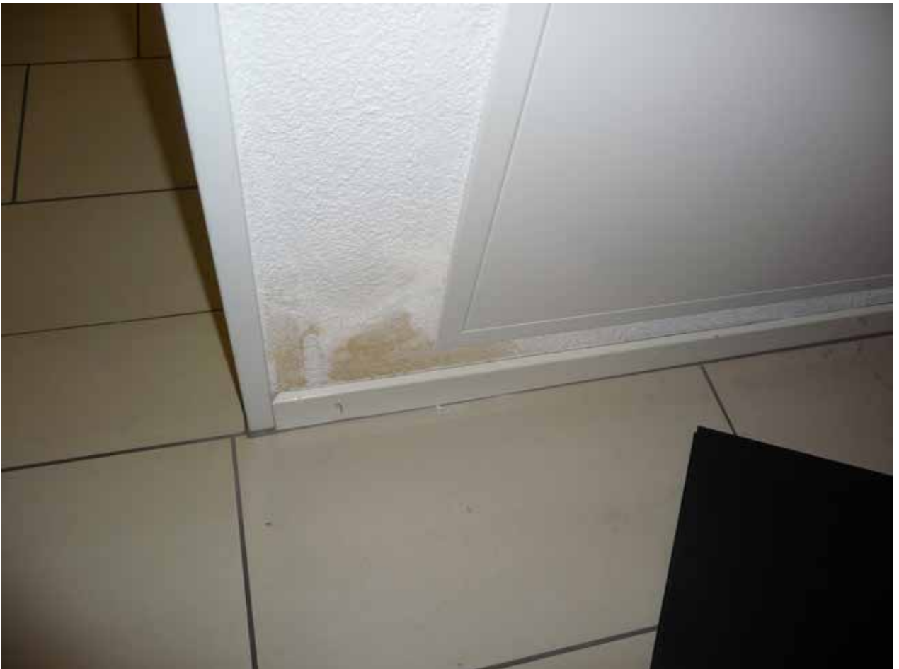
Wasserschaden bei UV Bodenheizung im Entree
