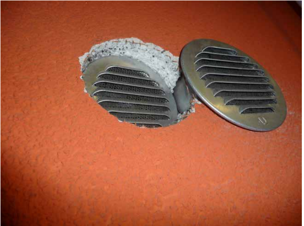
UG offener Ausschnitt Lüftung Technikraum
