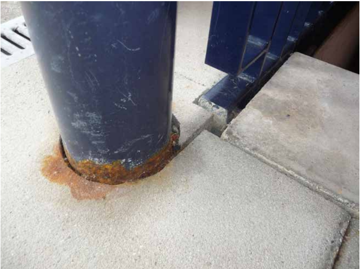
EG rostige Stützenfüß. Stehendes Wasser?
