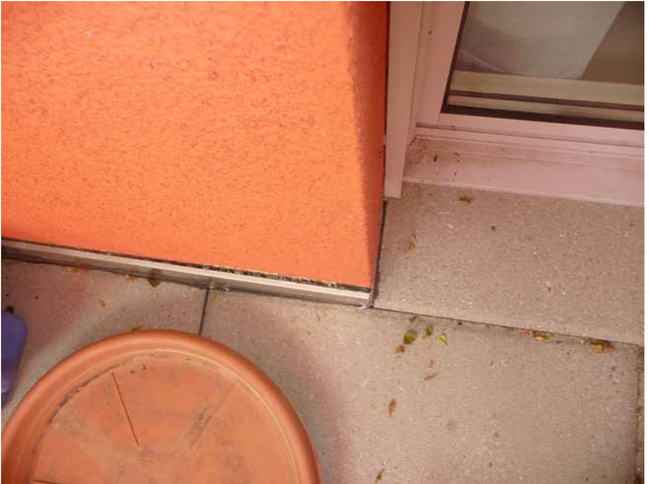
Ablösungen und Risse über Sockelblech bei Sitzplatz
