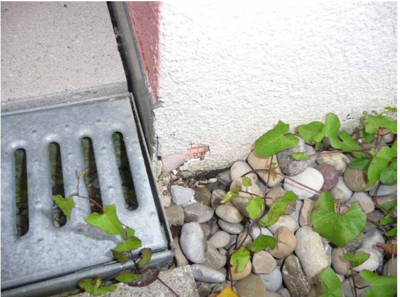
Putzschäden AWD bei Fassadensockel
